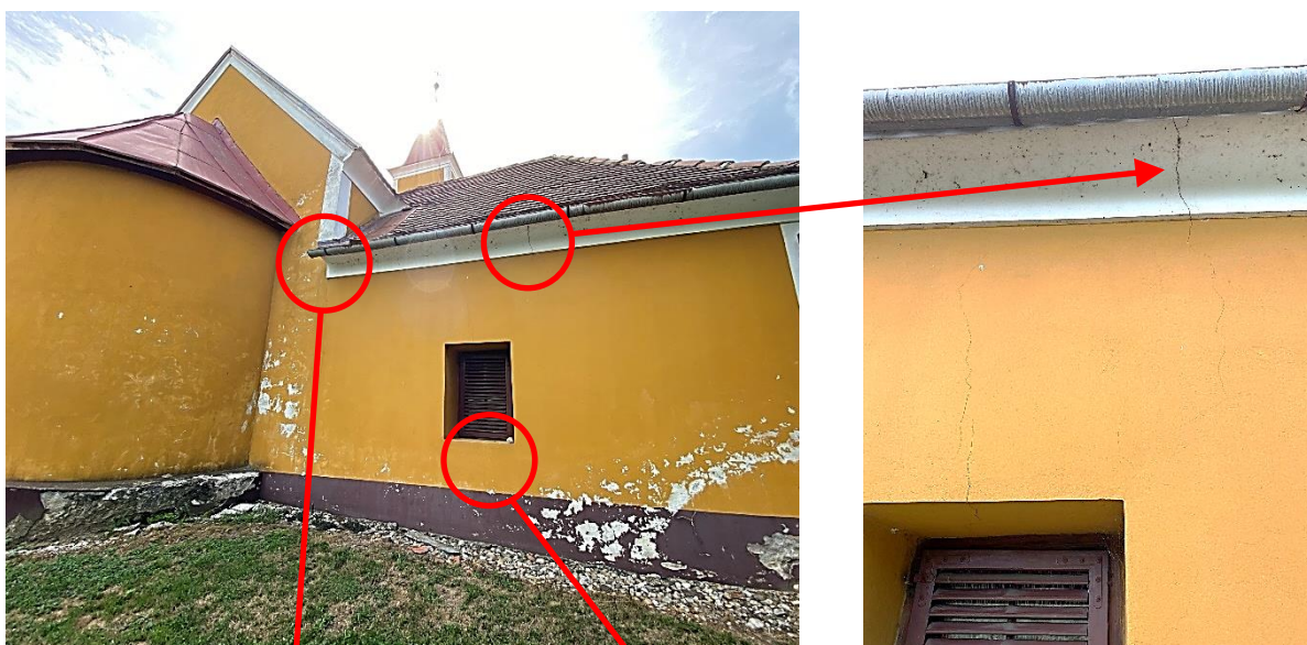
Slika 17. Desno pukotina O7
