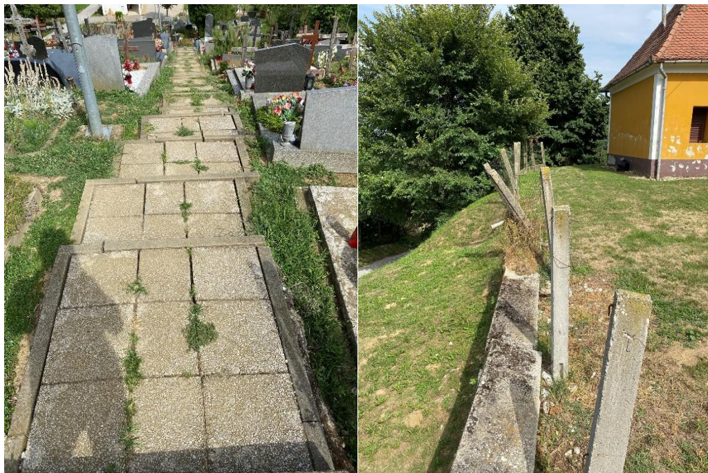
Slika 20. Jasno vidljivi znakovi padinskog puzanja sa istočne i sjeverne strane kapele. Ovdje je važno primijetiti neposrednu blizinu kapele kao i nagnute konstruktivne elemente koji upućuju na puzanje terena (stepenice, potporni zidovi te stupovi ograde).
