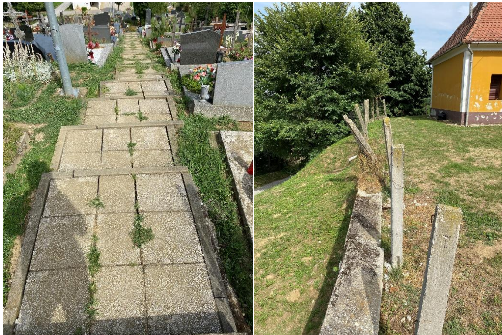
Slika 20. Jasno vidljivi znakovi padinskog puzanja sa istočne i sjeverne strane kapele. Ovdje je važno primijetiti neposrednu blizinu kapele kao i nagnute konstruktivne elemente koji upućuju na puzanje terena (stepenice, potporni zidovi te stupovi ograde).
