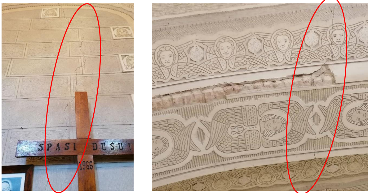
Slika 34. Vertikalna pukotina proteže se kroz cijelu visinu sjevernog zida te se širi dalje na istočno podtjemenu luka, odmah uz taj zid kapele
