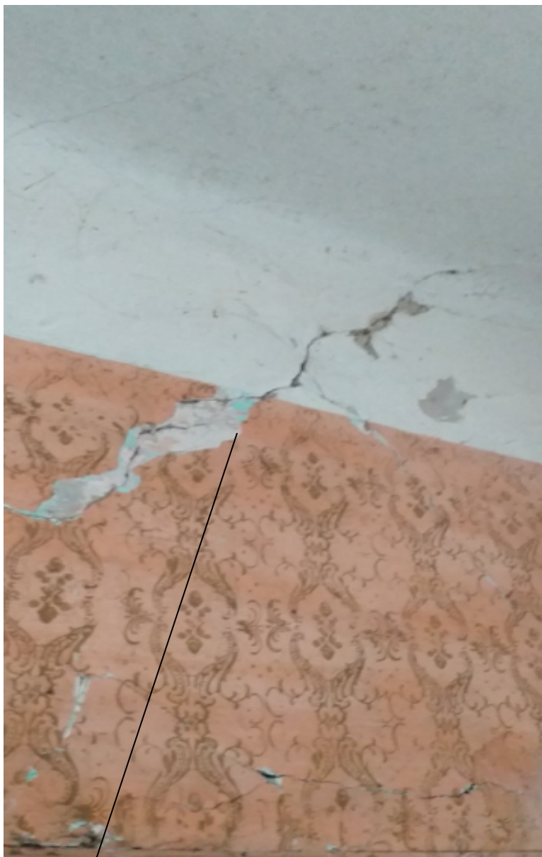
Slika 5.24. Prikaz pukotina- (oznaka na tlocrtu 1b)
