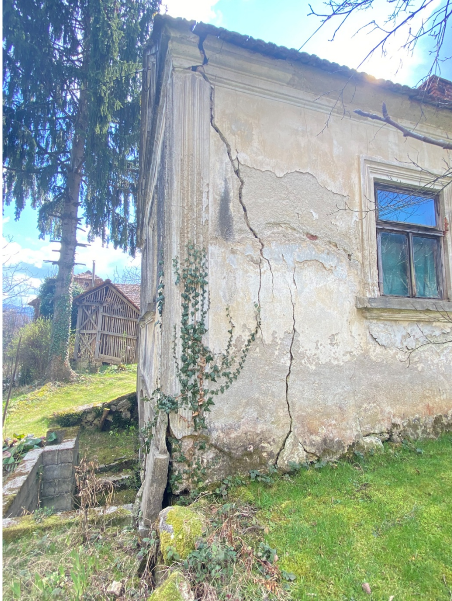
Slika 5.17. Oštećenja na sjevernom pročelju- (oznaka na tlocrtu 5c)
