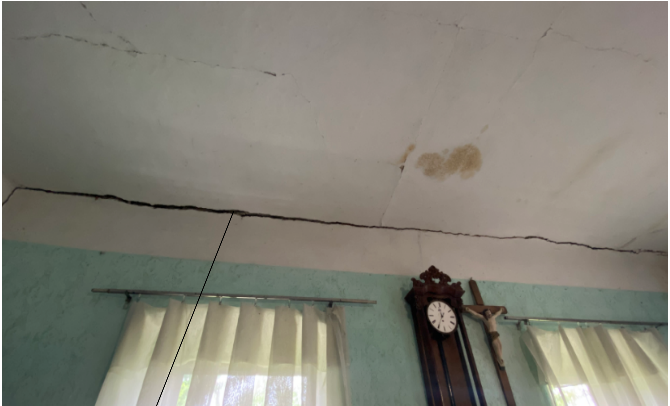
Slika 5.34. Pukotine na stropu – (oznaka na tlocrtu 4e)
