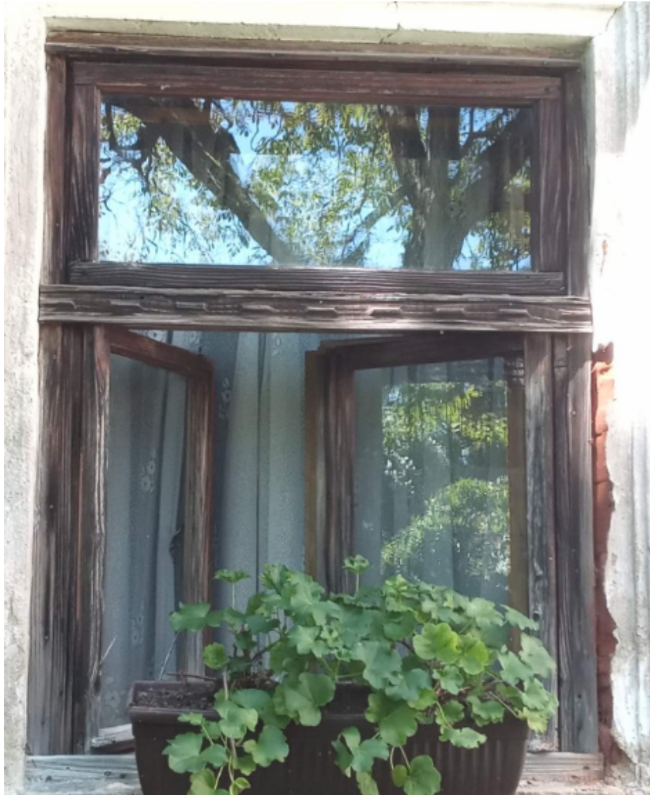
Slika 5.35. Prikaz istrunulih drvenih prozora
