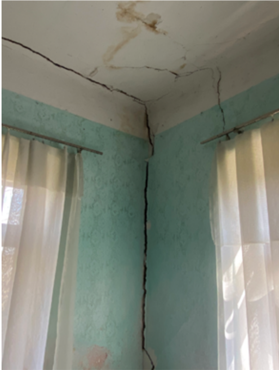
Slika 5.30. Pukotine na istočnom pročelju (desni ugao)-
