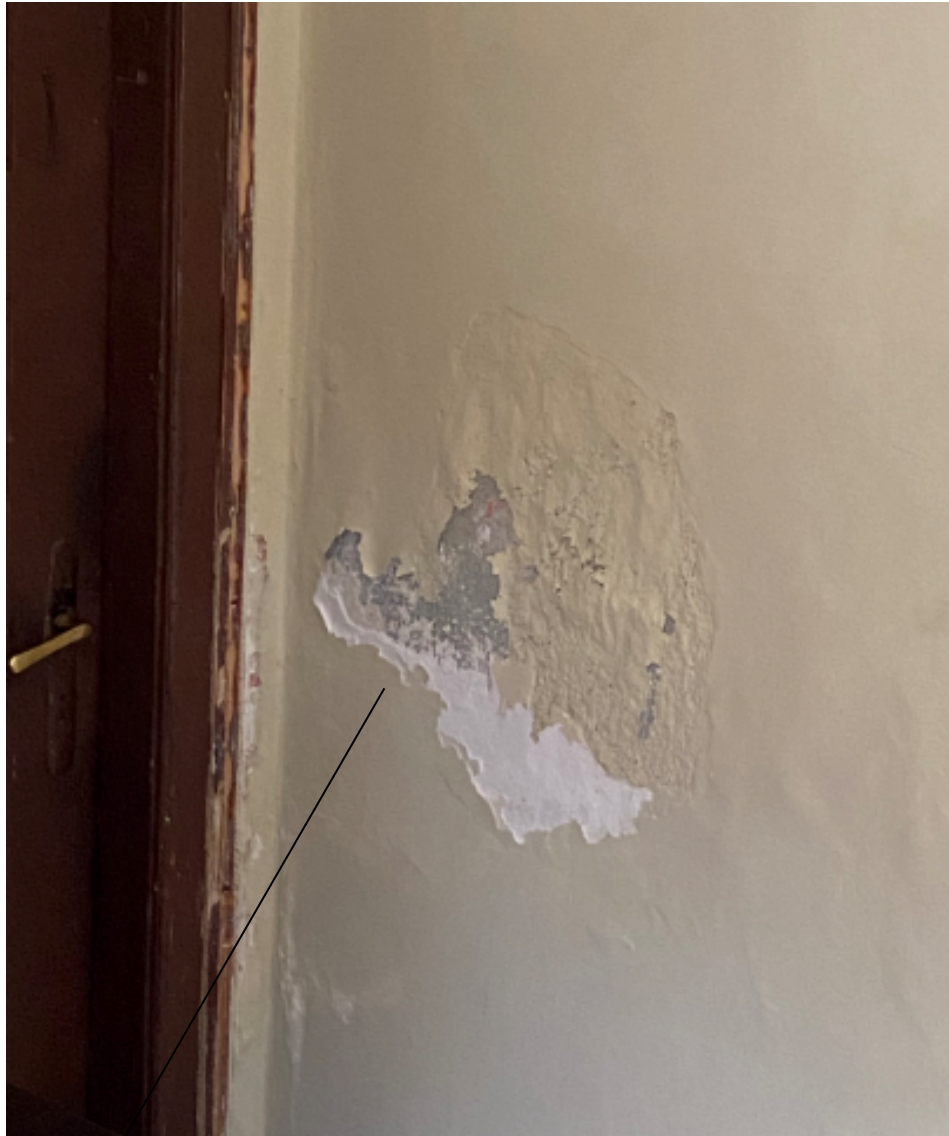
Slika 5.25. Prikaz vlage na unutarjem zidu- (oznaka na tlocrtu 2a)
