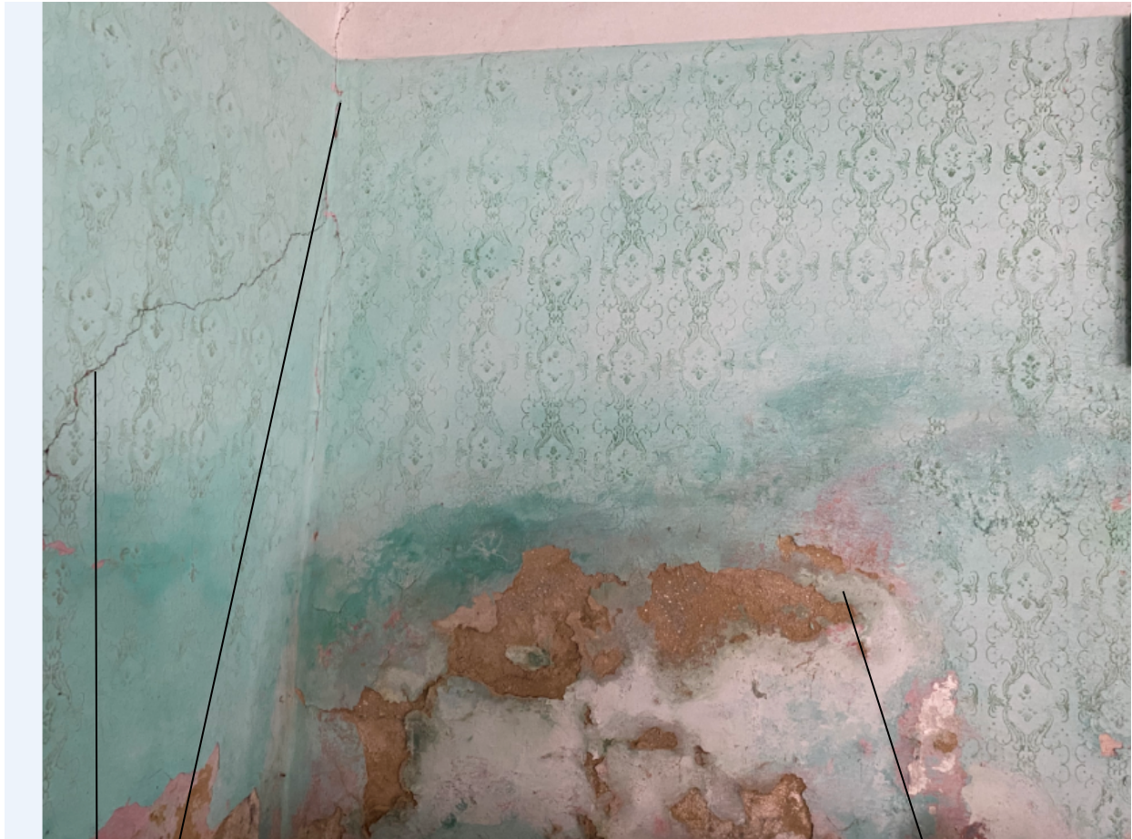
Slika 5.28. Prikaz vlage sa unutarnje strane zida- (oznaka na tlocrtu 4a,b)
