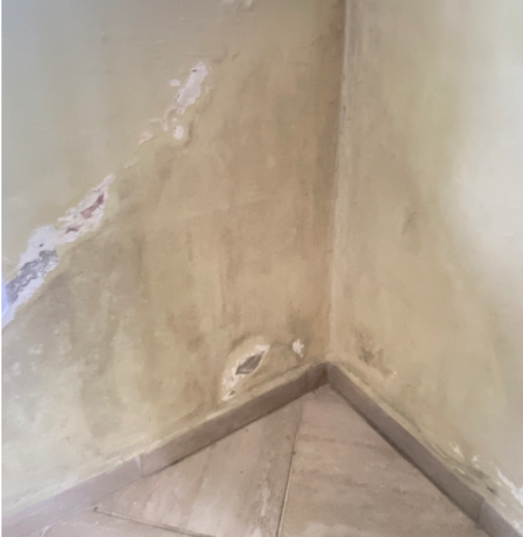
Slika 5.27. Vlaga na istočnom i južno zidu- (oznaka na tlocrtu 2b)
