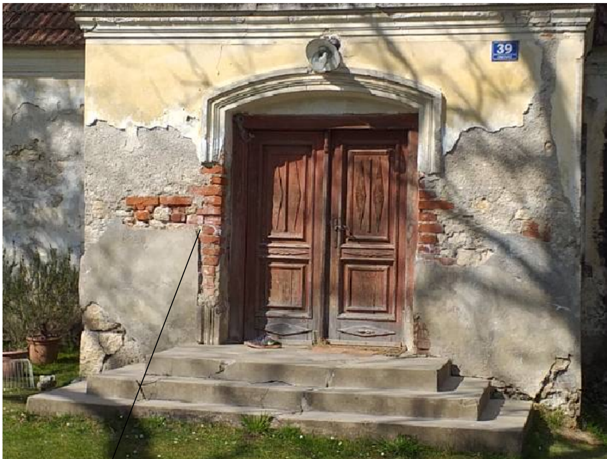
Slika 5.16. Raslojavanje zida na južnom pročelju- (oznaka na tlocrtu 5a)
