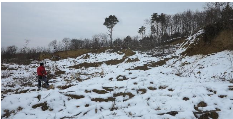
Slika 17: Iskolčenje pozicijskih točaka na osi budućeg nožićnog nasipa, u cilju provedbe kontrolnog dinamičkog sondiranja(LUS-DPL)[1]
