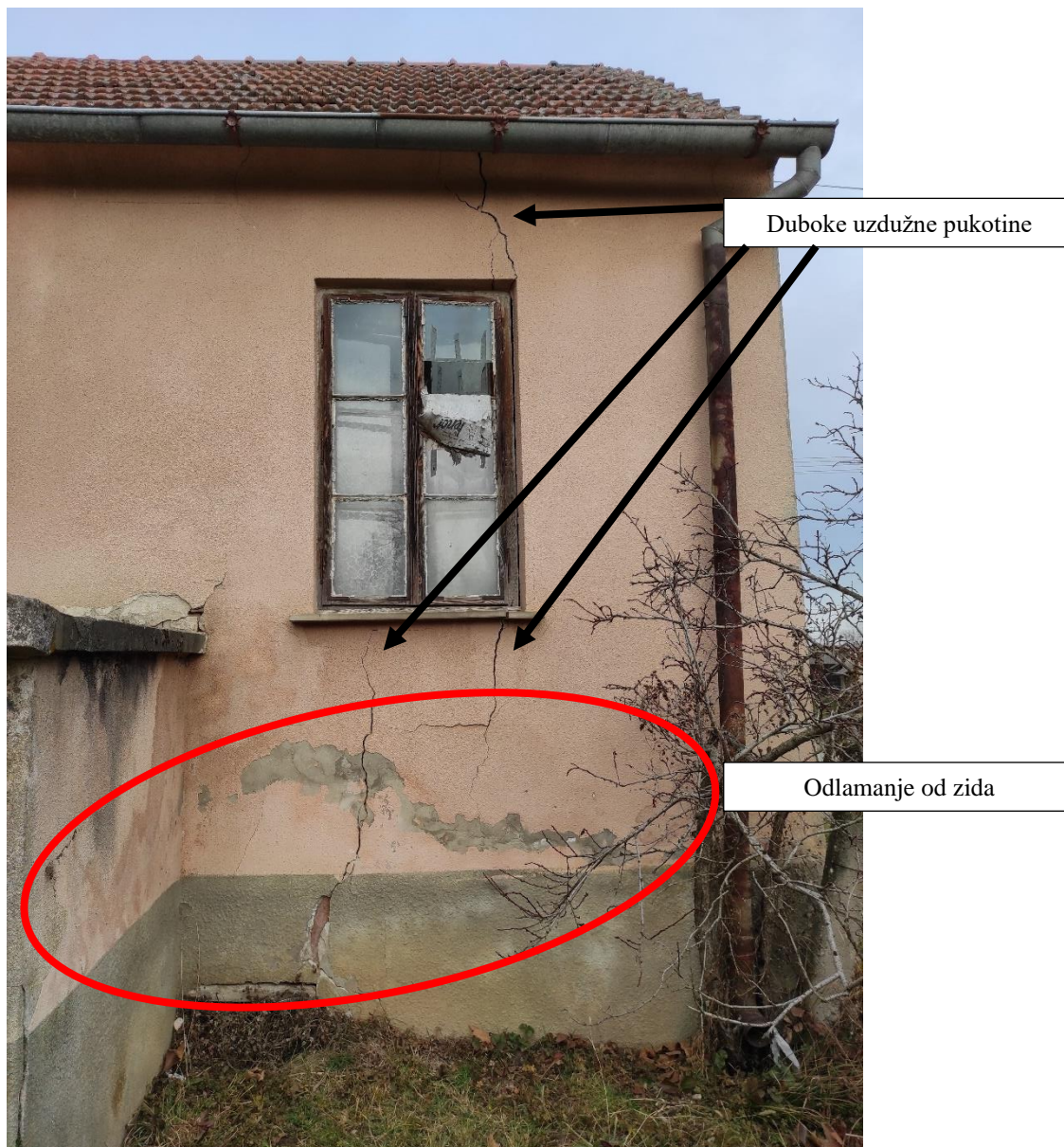
Slika 4.13 - Južno pročelje -duboke uzdužne pukotine, odlamanje od zida
