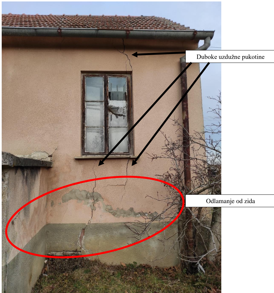
Slika 4.13 - Južno pročelje -duboke uzdužne pukotine, odlamanje od zida
