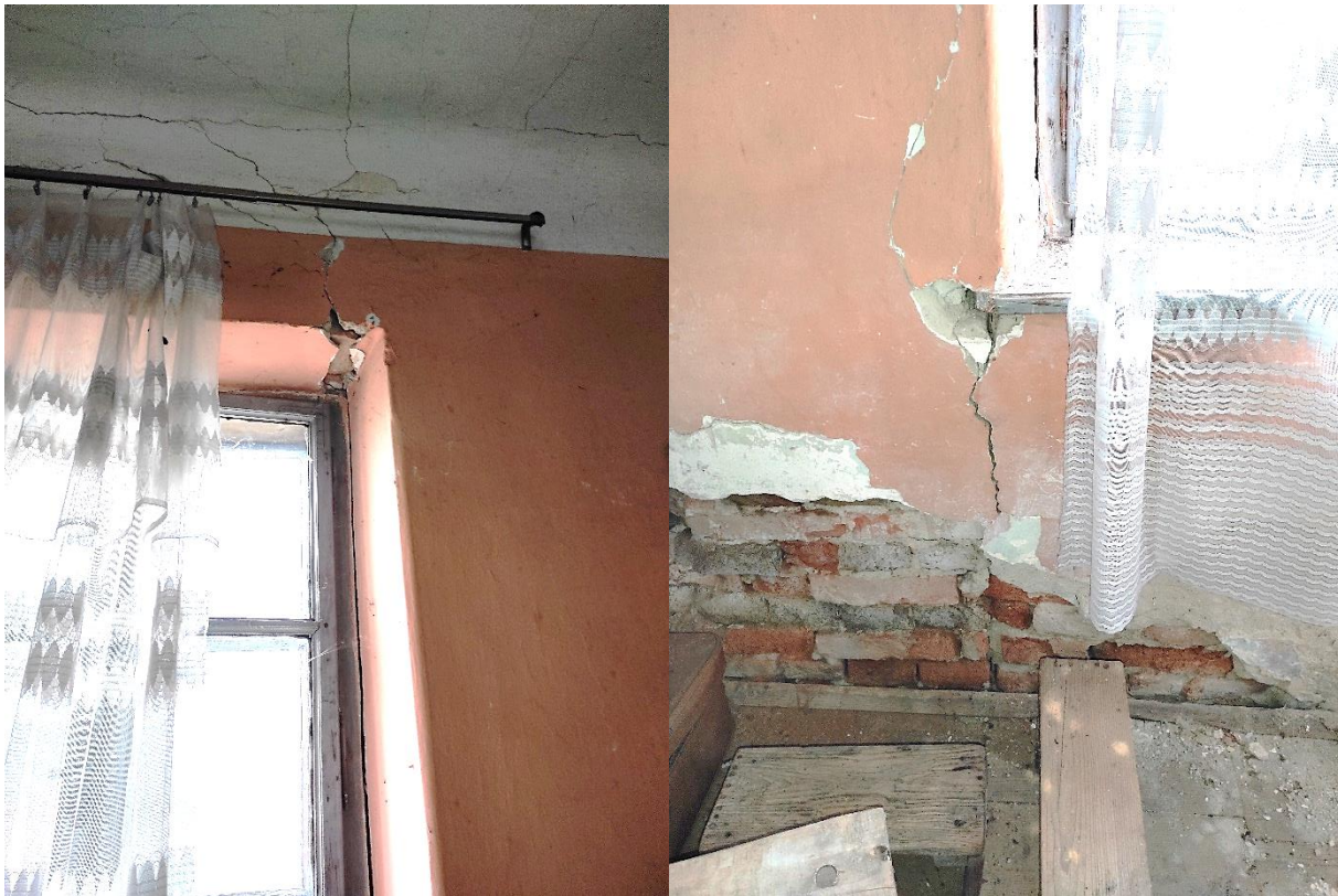
Slika 4.26 - Južno pročelje sa vanjske strane - dubinske pukotine
