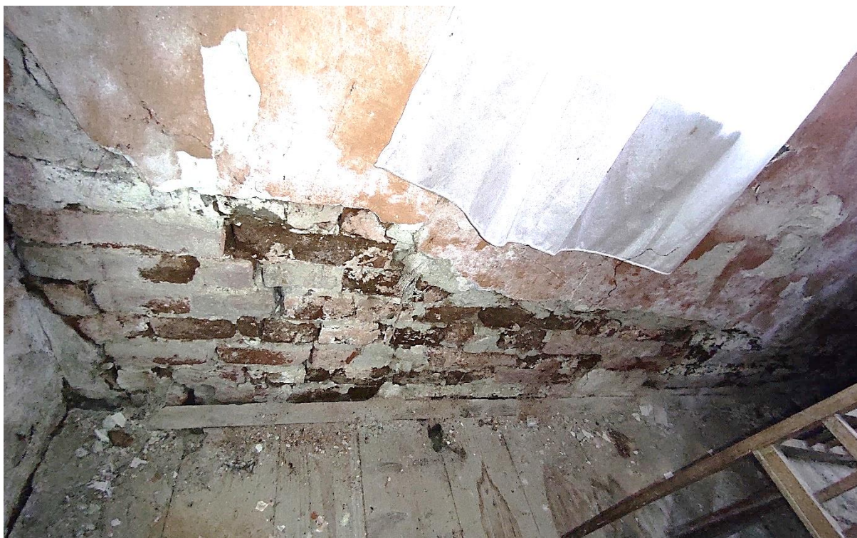
Slika 4.22 - Zapadno pročelje - odlamanjem većih dijelova građevnog materijala uslijed kapilarne i higroskopne vlage
