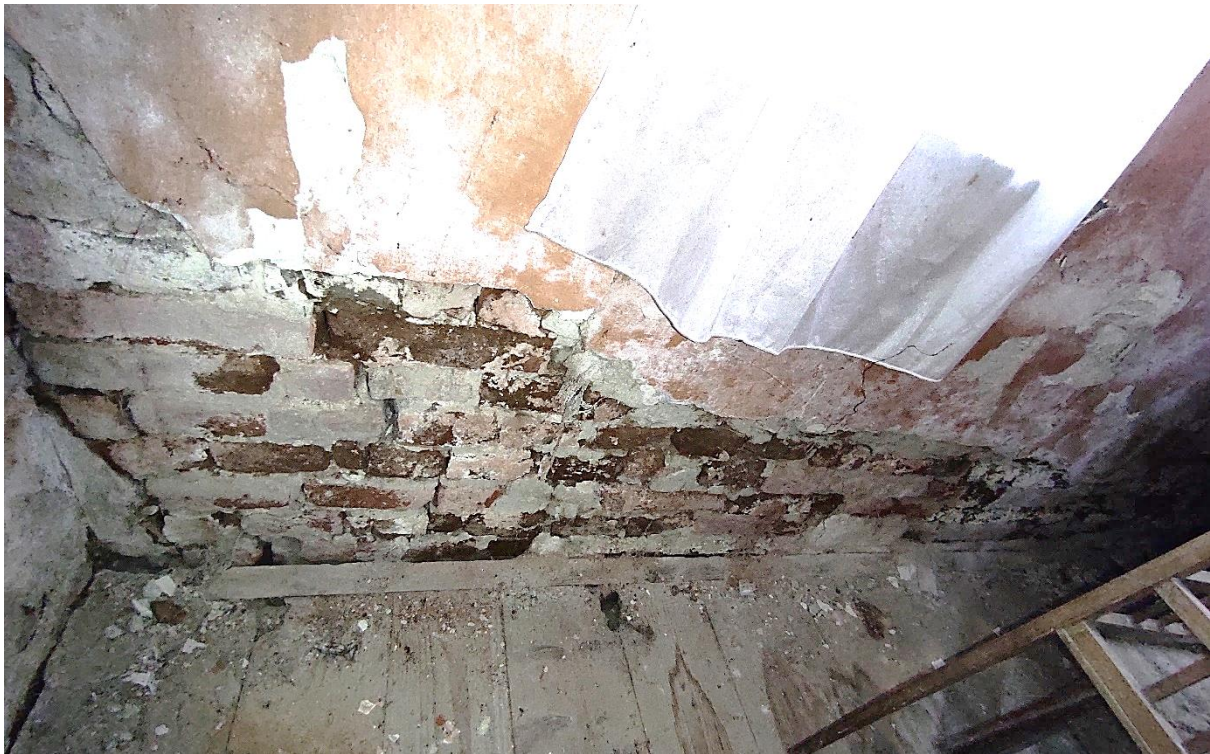
Slika 4.22 - Zapadno pročelje - odlamanjem većih dijelova građevnog materijala uslijed kapilarne i higroskopne vlage
