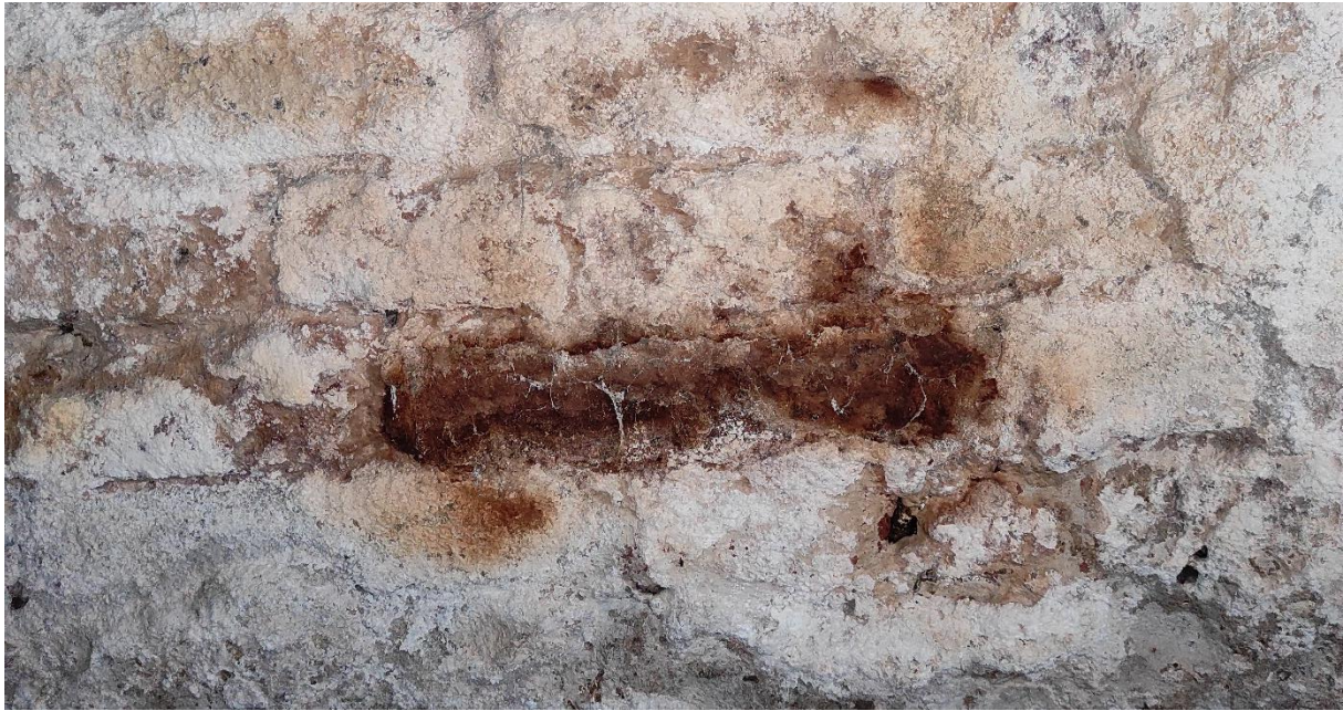
Slika 4.3 - Podrum - plijesni na površini zidova
