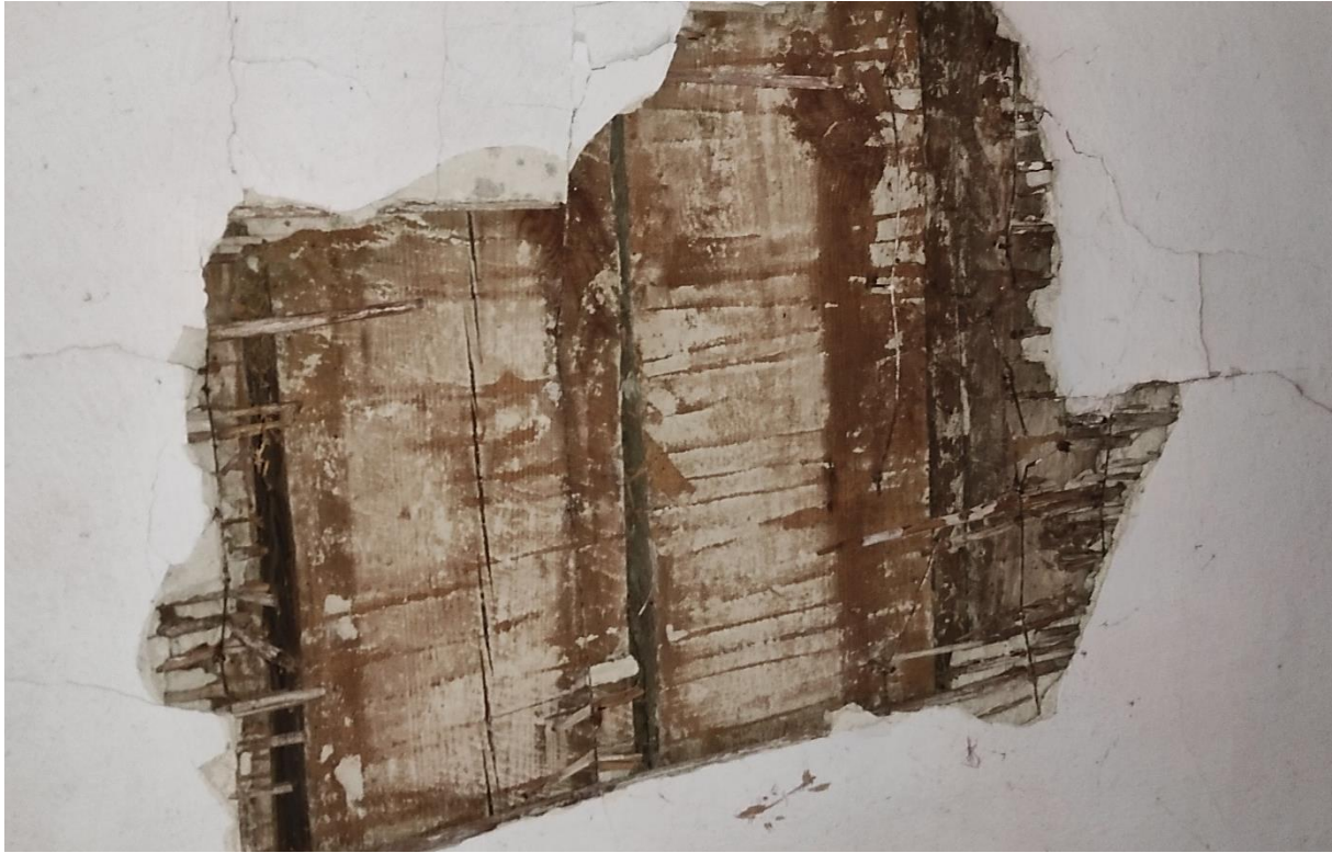
Slika 2.8 – Donji dio stropa u smočnici gdje je otpao dio žbuke sa trstikom
