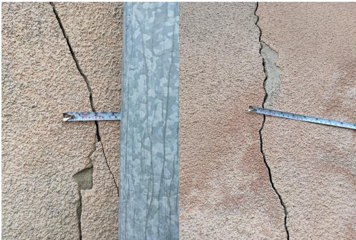
Slika 4.17 - Detaljan prikaz pukotina sa slike 4.16
