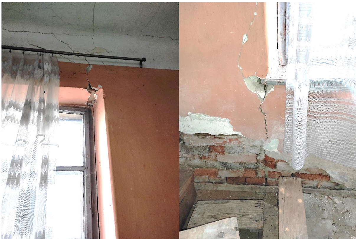
Slika 4.26 - Južno pročelje sa vanjske strane - dubinske pukotine
