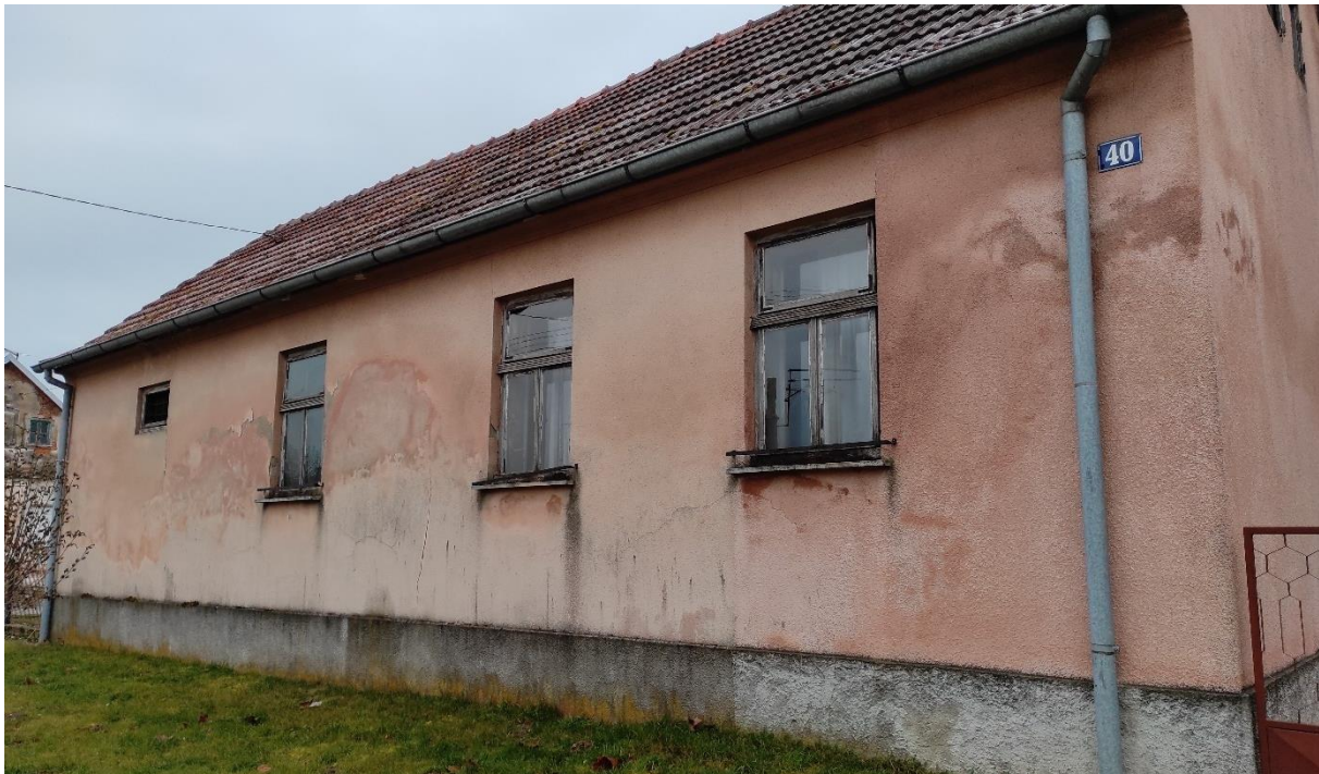
Slika 4.5 - Sjeverno pročelje - šteta od kapilarne vlage
