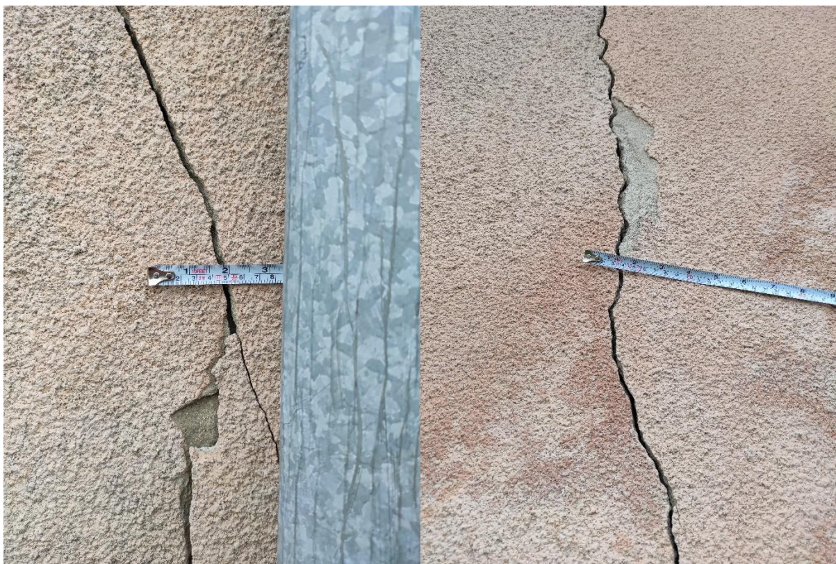
Slika 4.17 - Detaljan prikaz pukotina sa slike 4.16
