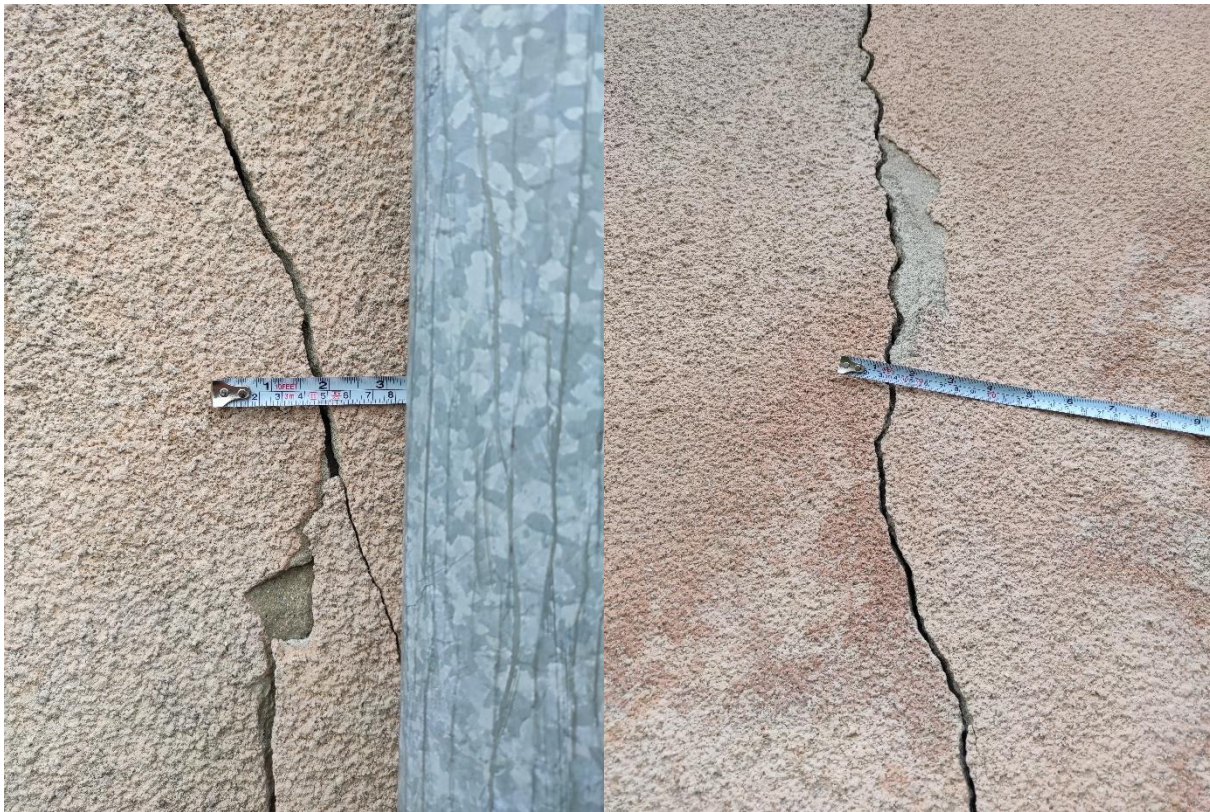
Slika 4.17 - Detaljan prikaz pukotina sa slike 4.16
