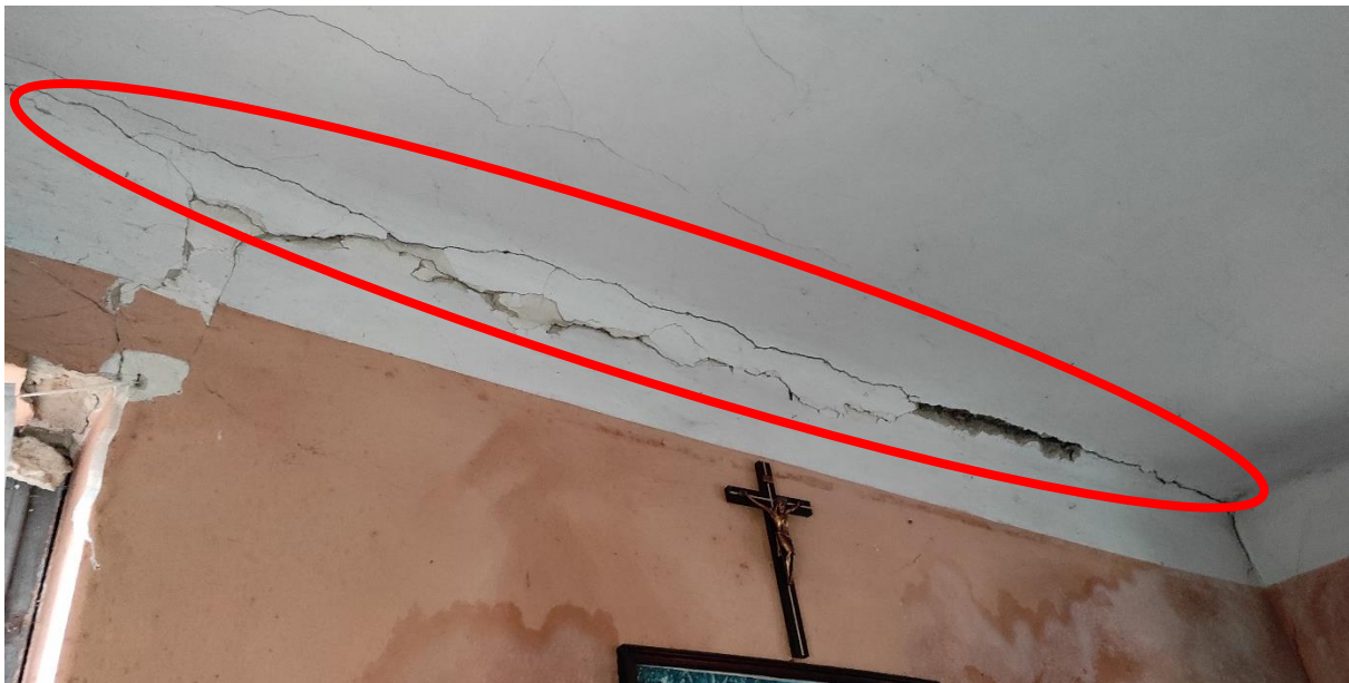
Slika 4.19 - Zapadno pročelje - pukotina na spoju zida i stropa
