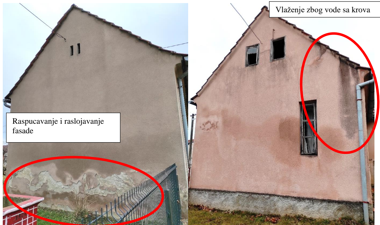
Slika 4.6 - Istočno pročelje - raspucavanje i raslojavanje fasade
