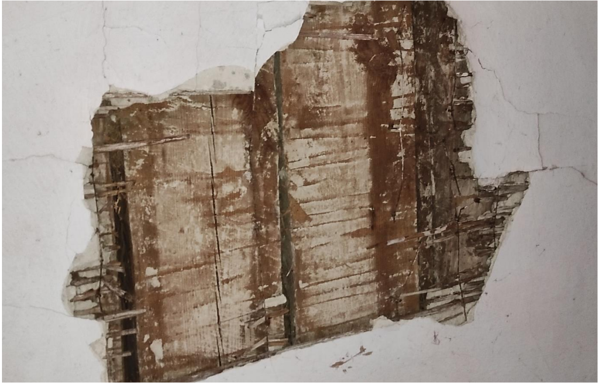
Slika 2.8 – Donji dio stropa u smočnici gdje je otpao dio žbuke sa trstikom
