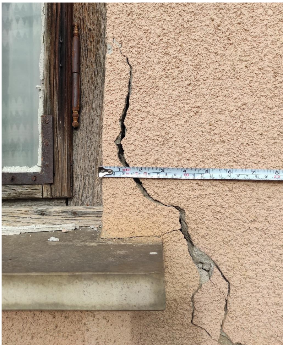
Slika 4.11 - Detaljan prikaz pukotine sa slike 4.10 desno od prozora
