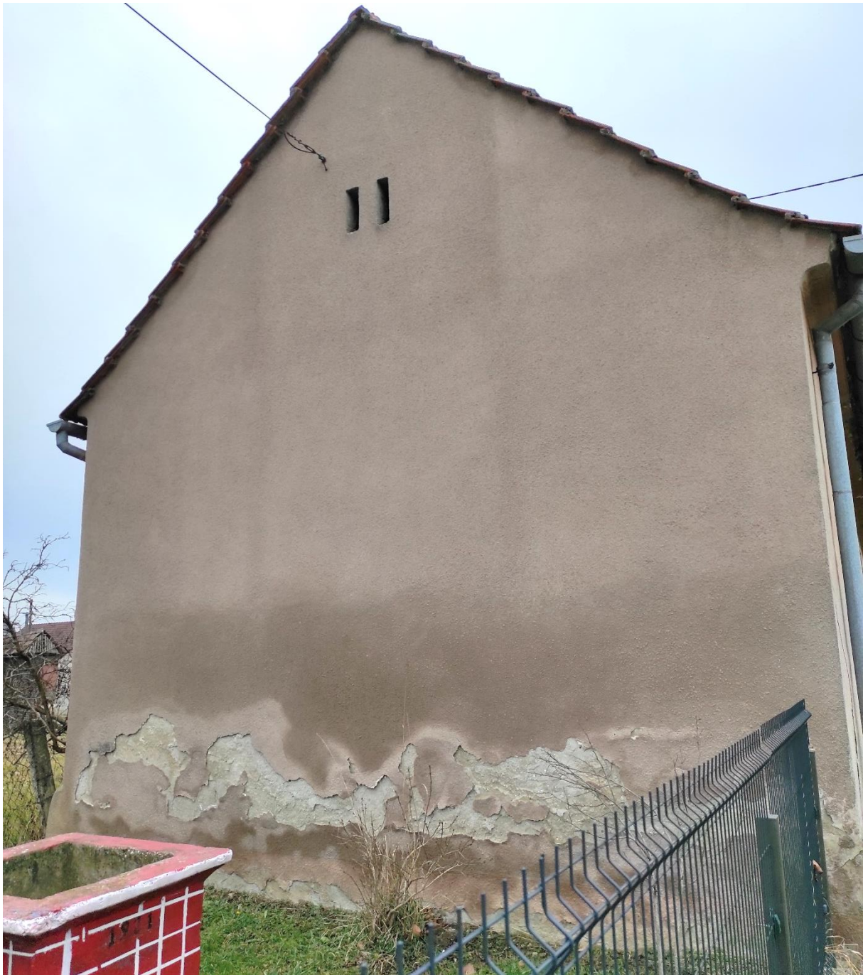
Slika 3.1 – Prikaz štete nastale kapilarnom vlagom na istočnom pročelju obiteljske kuće u Pušćinama
