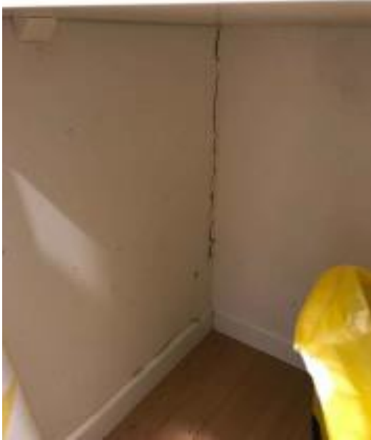
Slika 3.19. stanje pregradnih zidova 1
