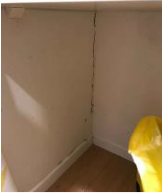
Slika 3.19. stanje pregradnih zidova 1
