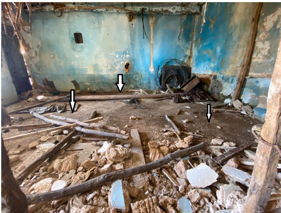
Fotografija 33: Oštećenja na podu [3]
