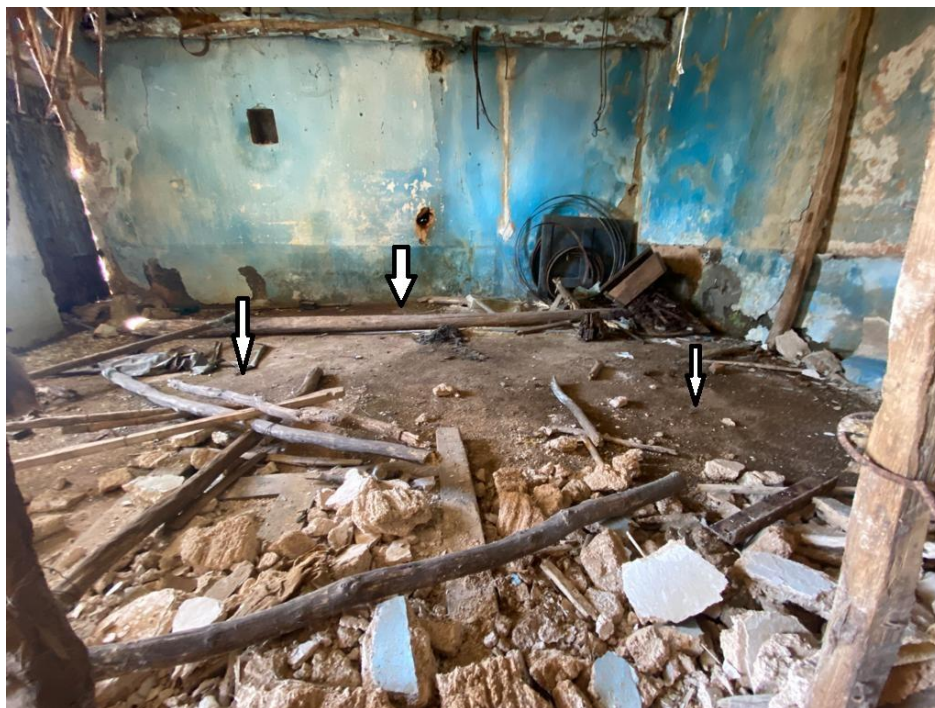
Fotografija 33: Oštećenja na podu [3]
