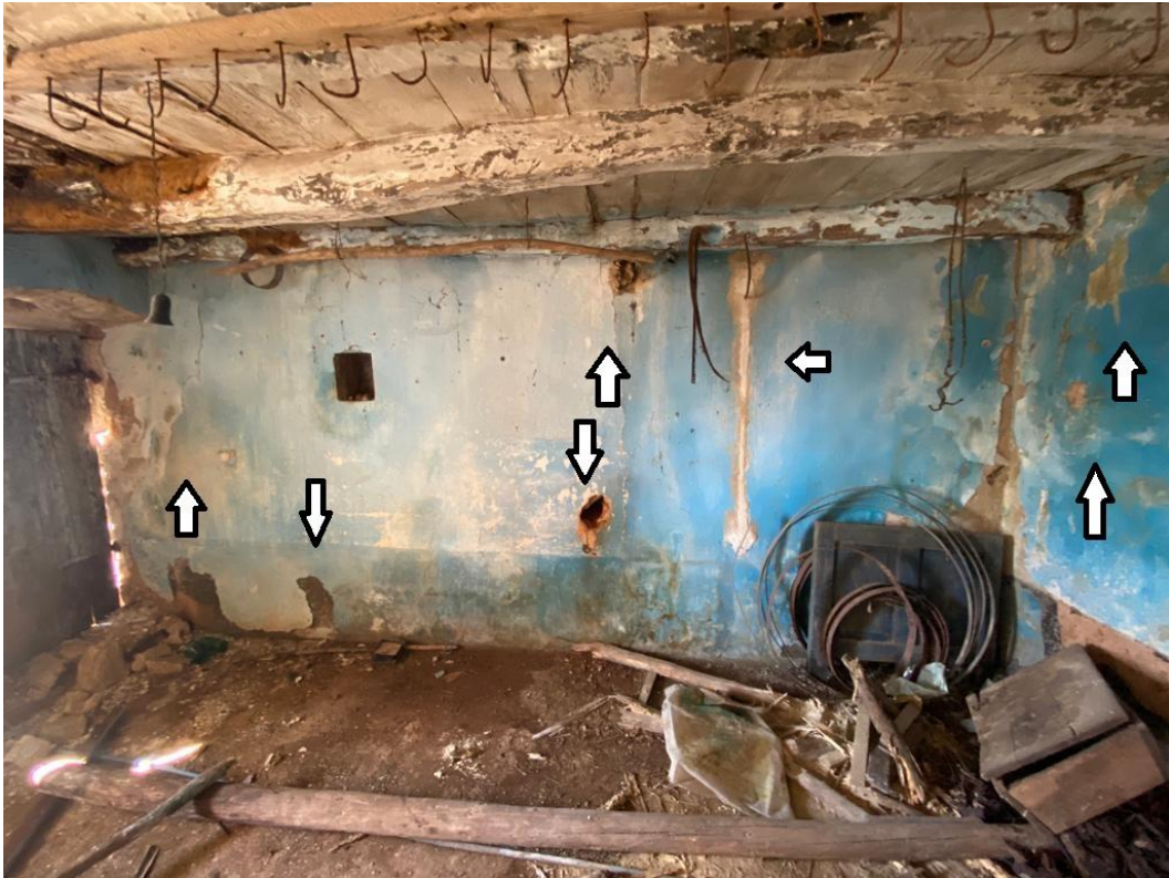
Fotografija 29: Oštećenja na žbuci uzrokovana vlagom [3]
