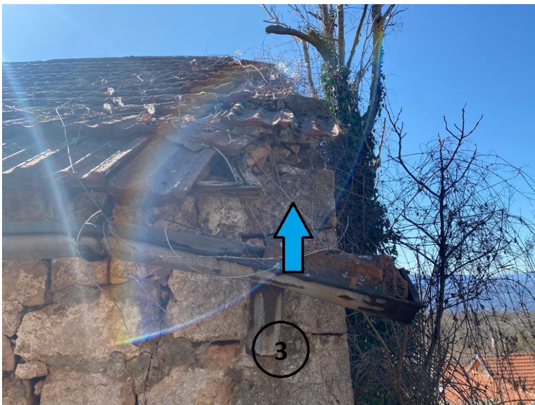
Fotografija 16: Oštećenja vanjskog zida sjeveroistočne strane - DETALJ [3]
