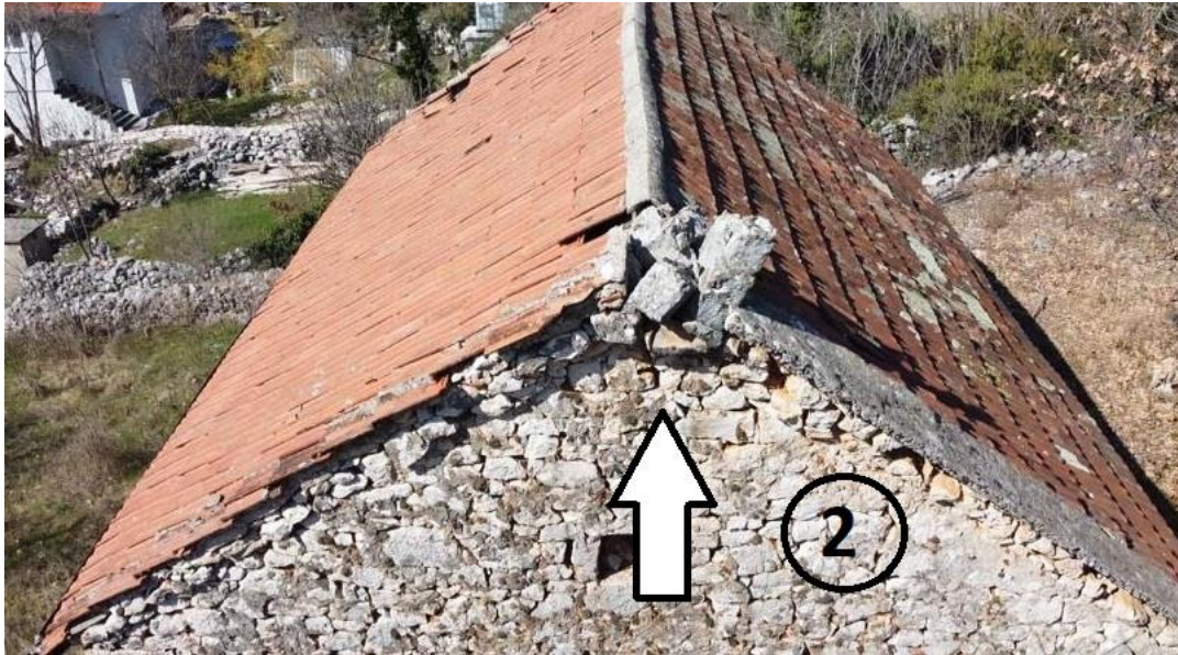
Fotografija 24: Oštećenje zabatnog zida i samog sljemena krovišta (označeno sa br. 1); Oštećenje dimnjaka (označeno sa br. 2); Oštećenje oluka (označeno sa br. 3); Oštećenje crijeva (označeno sa br. 4) [3]
