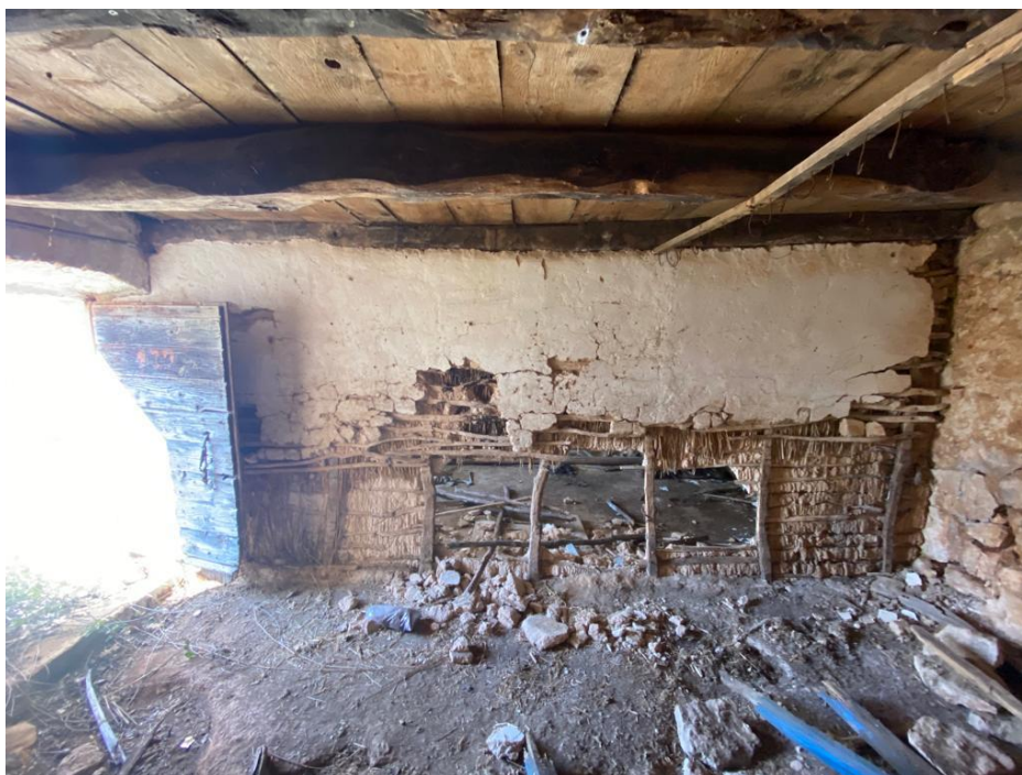
Fotografija 32: Oštećenja na pregradnom zidu [3]
