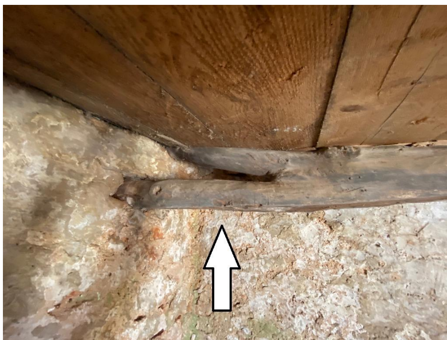
Fotografija 36: Oštećenja na međukatnoj konstrukciji [3]
