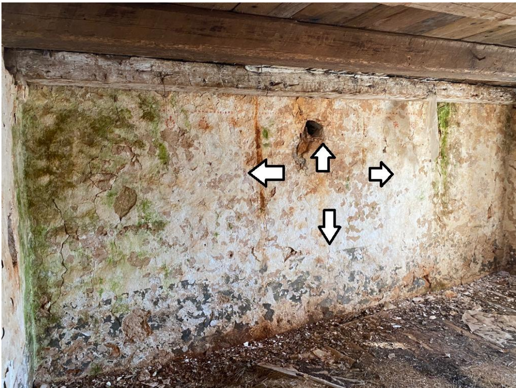
Fotografija 30: Oštećenja na žbuci uzrokovana vlagom [3]
