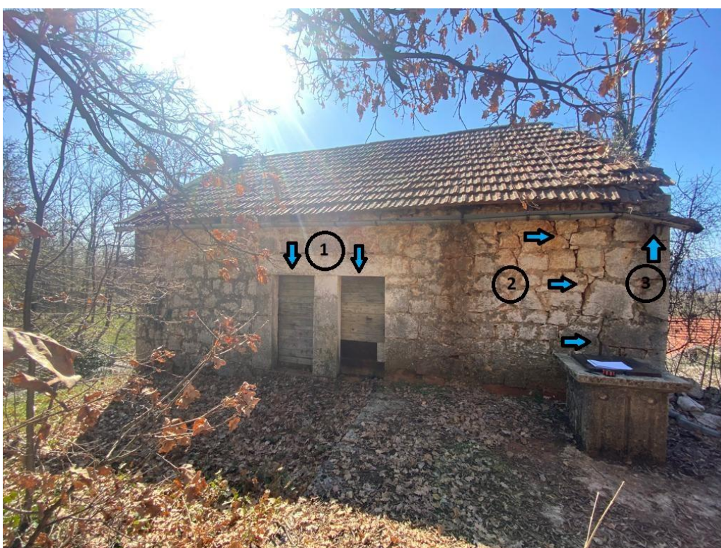
Fotografija 14: Oštećenja vanjskog zida sjeveroistočne strane [3]
