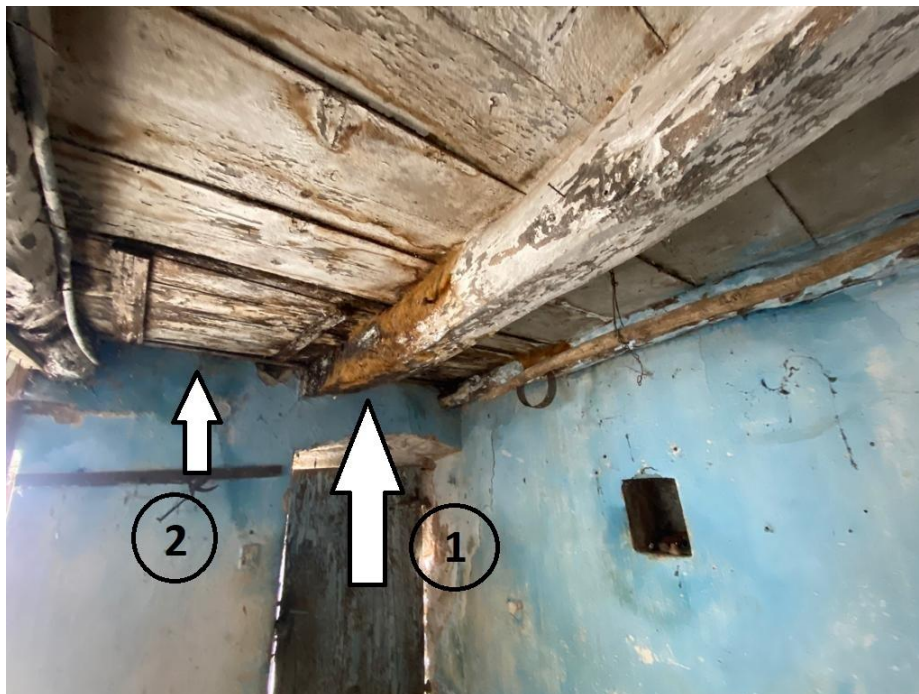
Fotografija 35: Oštećenja na međukatnoj konstrukciji [3]
