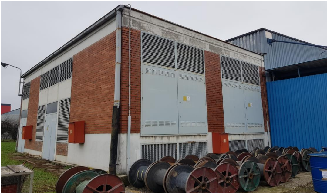
Slika 11. Transformatorska stanica snage 1 MVA
