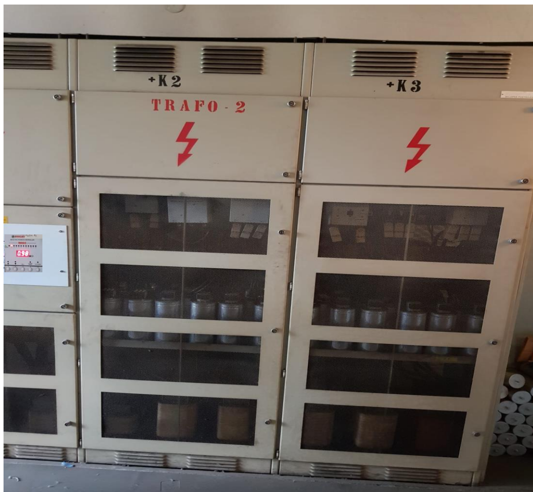
Slika 16. Kompenzacijski ormar u transformatorskoj stanici TS1
