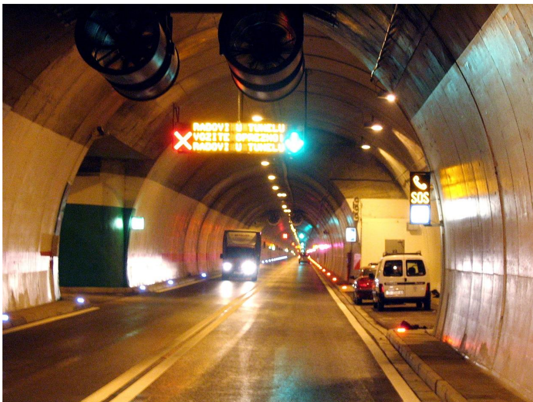
Slika 33. Prometna i ostala oprema u tunelu-oznake evakuacijskih puteva, ventilatori, razglas, senzori vidljivosti..
