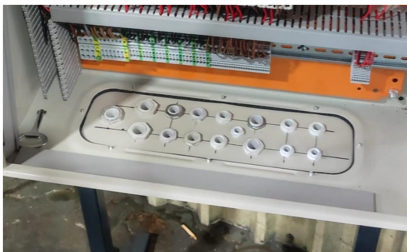
Slika 4.5. Postavljene uvodnice u novom ormaru
