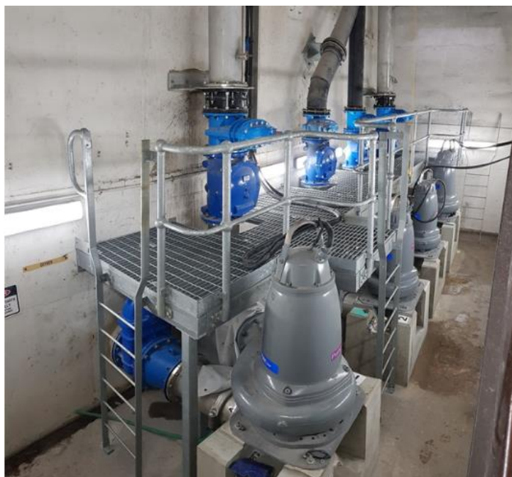
Slika 23. Strojarnica crpne stanice [29]
