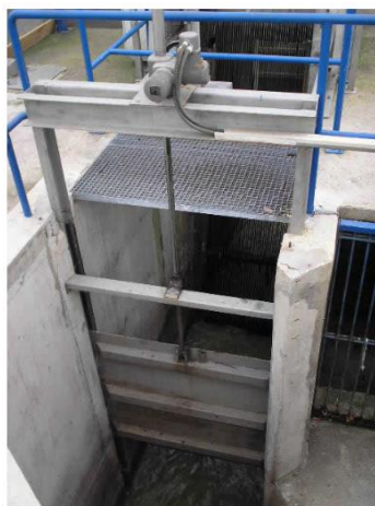
Slika 19. Automatska pločasta zapornica [25]
