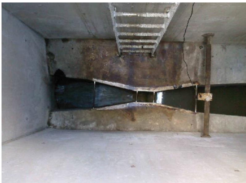
Slika 12. Parshallovo suženje instalirano na dovodnom kanalu [18]
