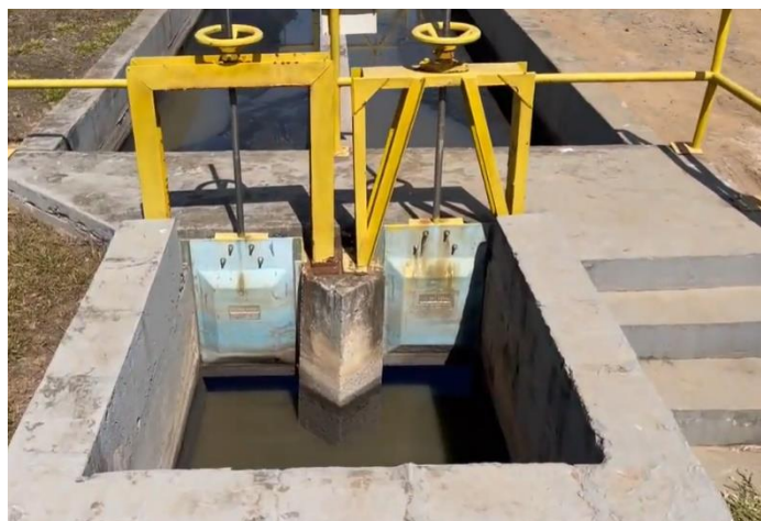
Slika 24. Ulazni bazen s vertikalnim pločastim zapornicama [30]
