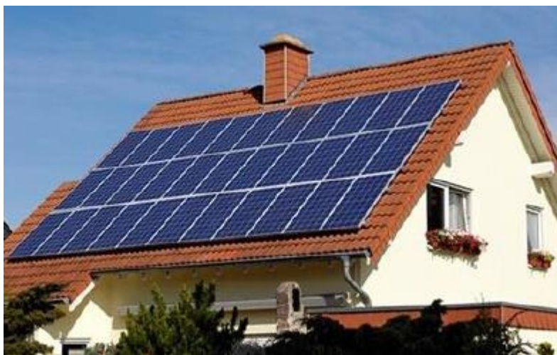
Slika 38 Primjer solarne elektrane na kosom krovu
