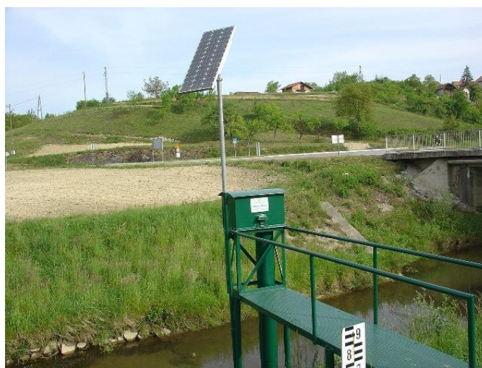
Slika 3.1.1. Vodomjerna stanica Lepoglava [6]
