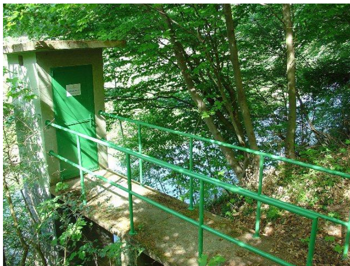
Slika 3.2.1. Vodomjerna stanica Željeznica [6]
