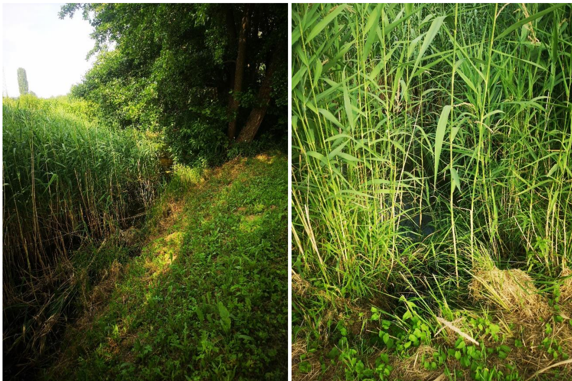
Slika 5.2.9. Derivacijski kanal zamuljen i obrasli vegetacijom (21.06.2023.)[12]
