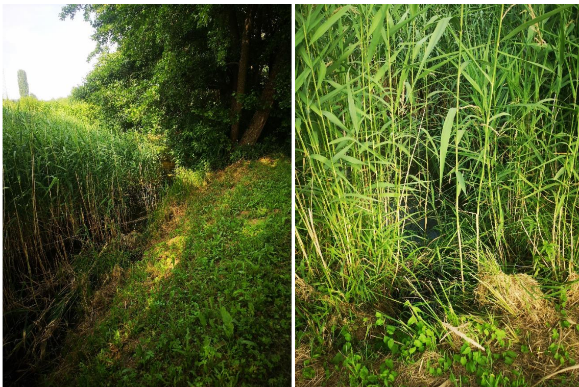
Slika 5.2.9. Derivacijski kanal zamuljen i obrasli vegetacijom (21.06.2023.)[12]
