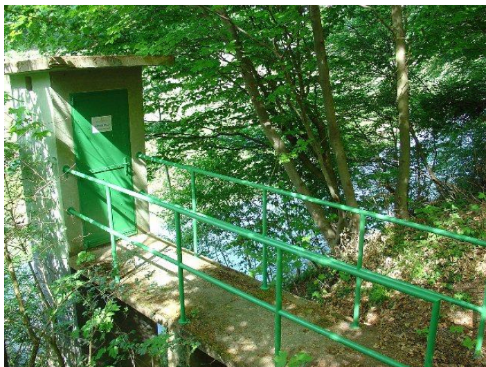
Slika 3.2.1. Vodomjerna stanica Željeznica [6]
