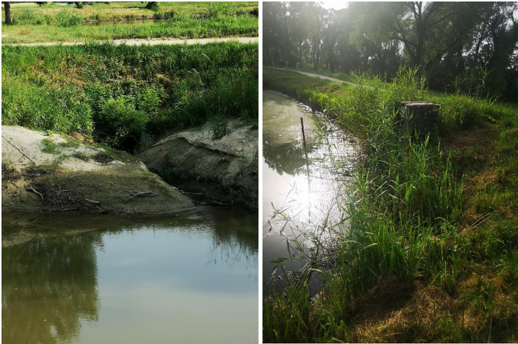
Slika 5.2.18. Propust za punjenje mrtvaje (21.06.2023.)[12]
