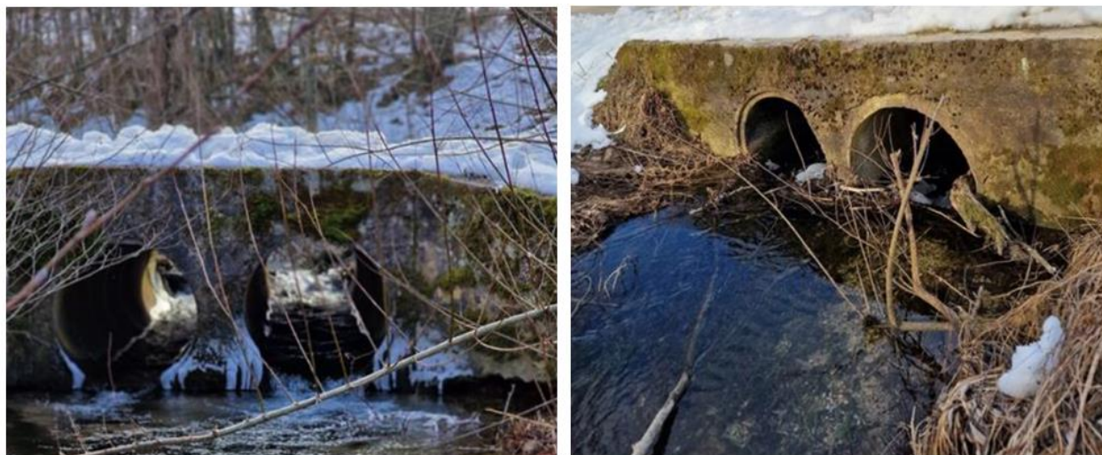
Slika 27. Pločasti propust - ŽC 3257; Stacionaža: km 0+170
