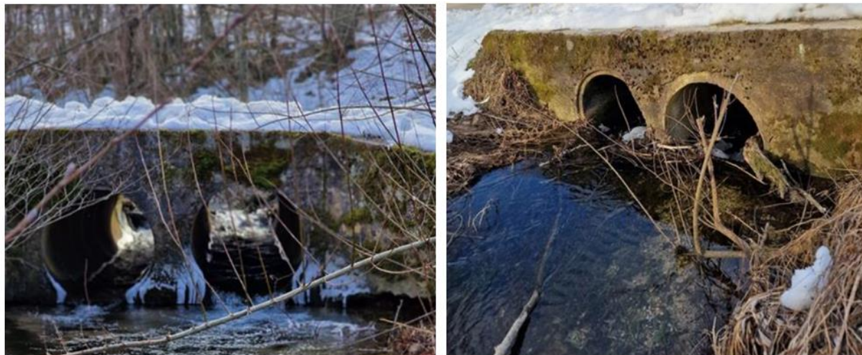
Slika 27. Pločasti propust - ŽC 3257; Stacionaža: km 0+170
