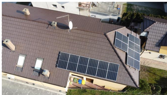
Slika 4.9. FN-moduli na južnoj i zapadnoj strani krovne površine
