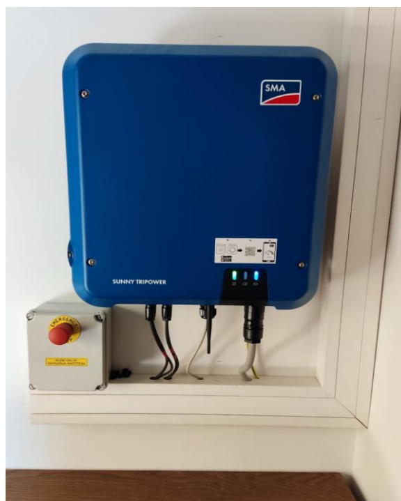
Slika 4.21. Instalirani predmetni inverter SMA SUNNY TRIPOWER 4.0
