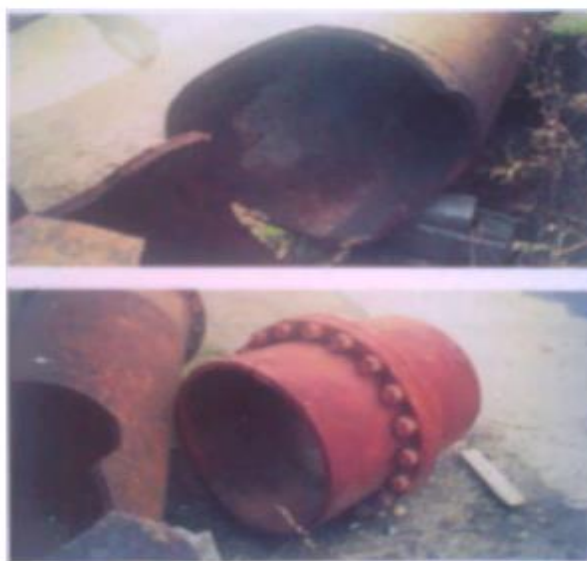
Slika 7.5. Izgleda cjevovoda nakon hidrauličkog udara [12]
