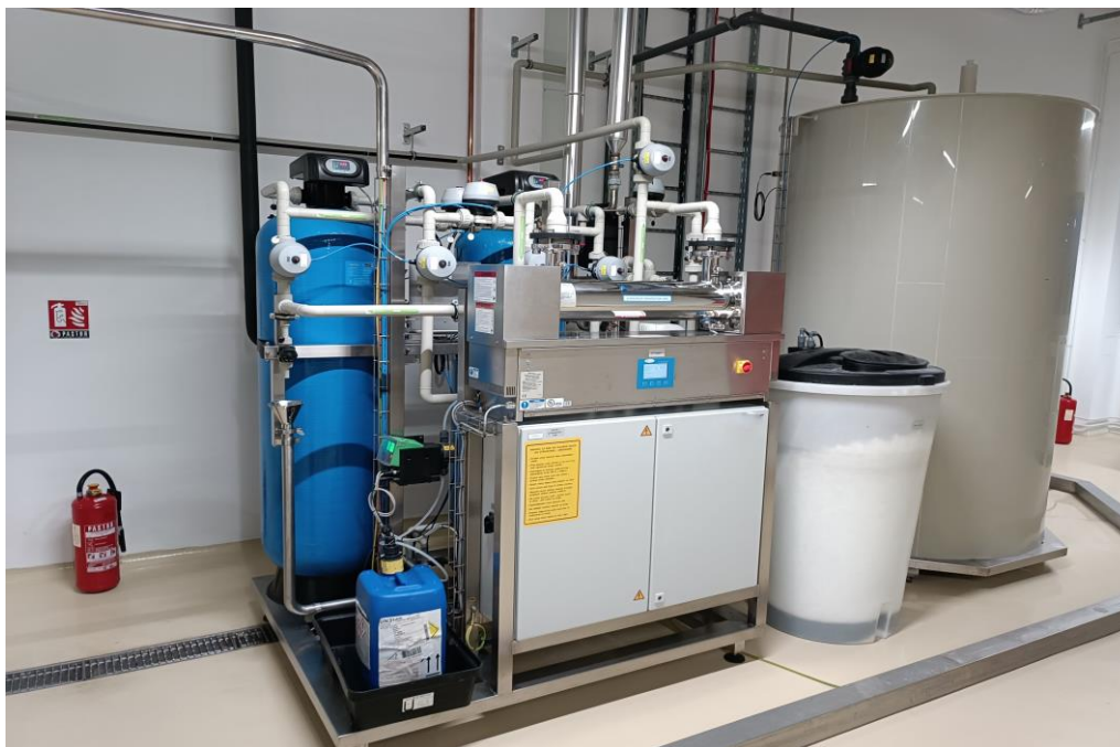
Slika 3. Predpriprema tehnološke vode (Izvor: Autor)
