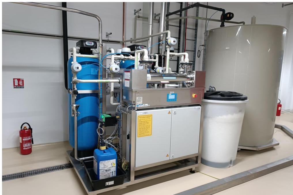
Slika 3. Predpriprema tehnološke vode (Izvor: Autor)
