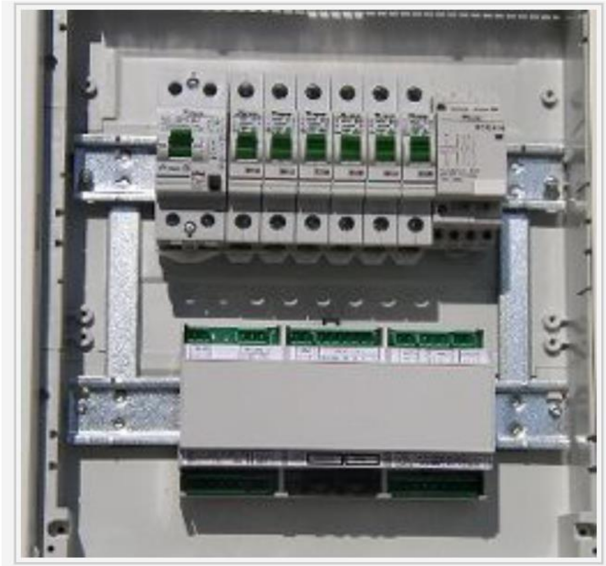
Slika 3.2 Podstanica ugrađena u elektro ormaru [3]
