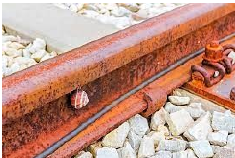
Slika 2.5. Prikaz opće korozije [7]
