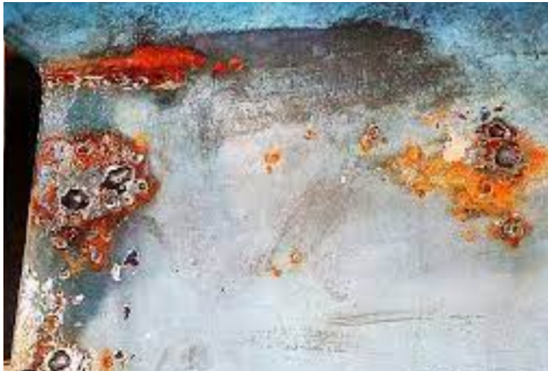
Slika 2.7. Prikaz pjegaste korozije [1]
