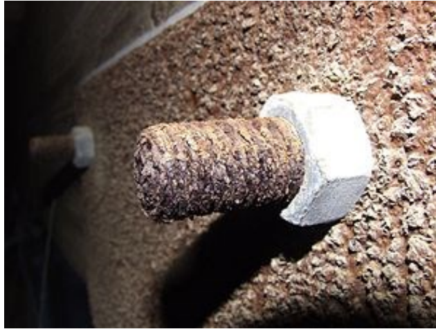
Slika 2.10. Prikaz galvanske korozije između vijka i matice [12]
