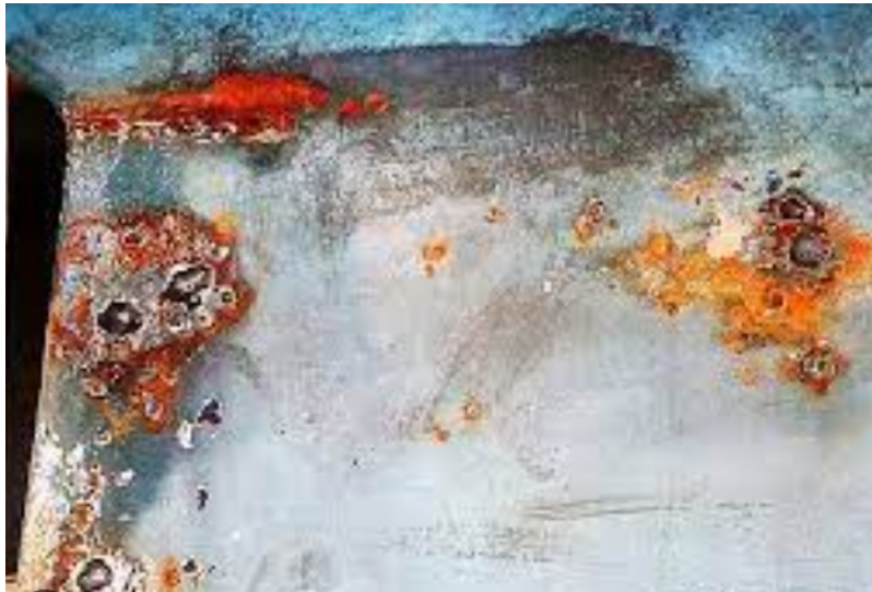
Slika 2.7. Prikaz pjegaste korozije [1]
