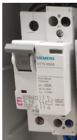
Slika 3.4.2. Osigurač i sklopnik
