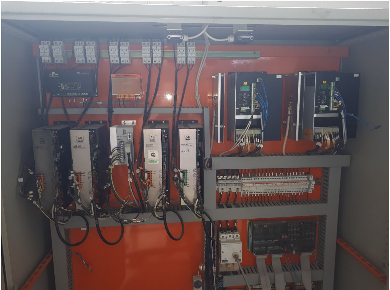
Slika 9.5 Električni ormar CNC stroja.
