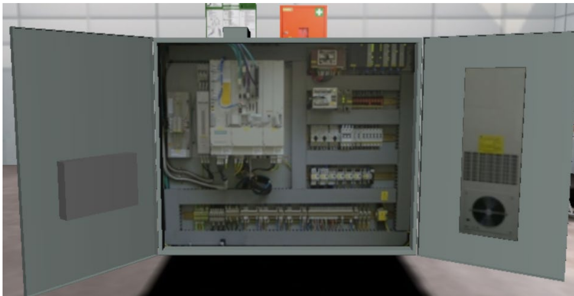
Slika 2.5 Upravljački ormar CNC stroja [3]
