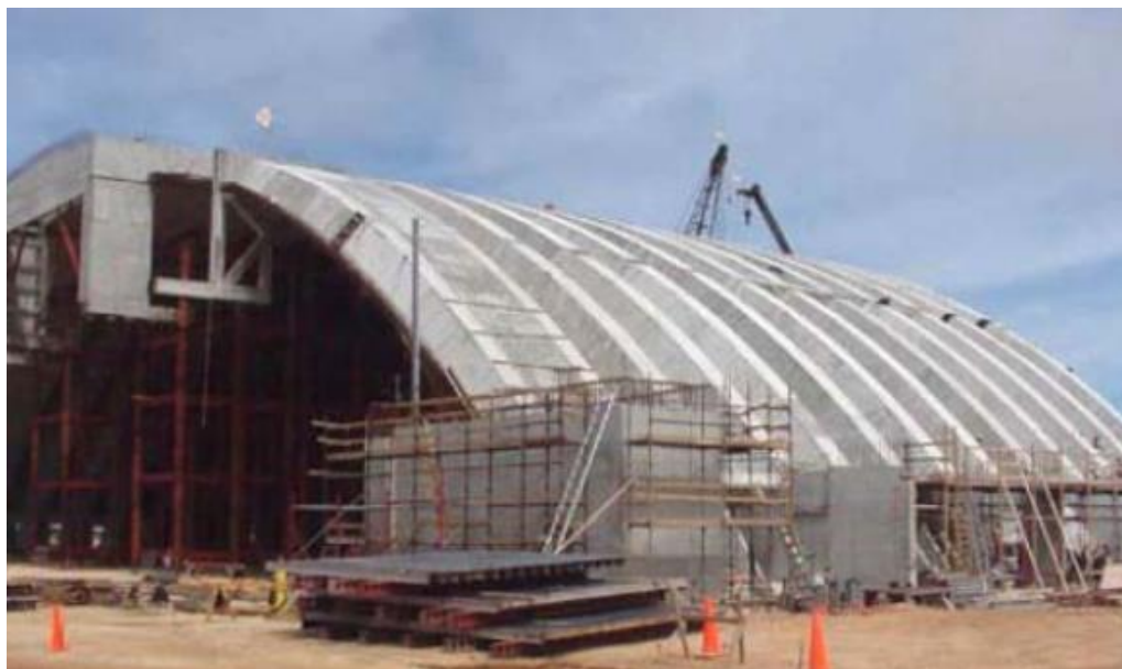
Slika 1.4. Hangar za održavanje zrakoplova u Guamu
