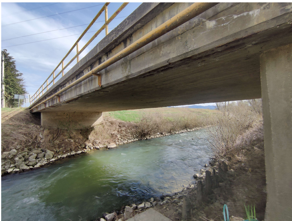
Slika 25: Oštećenje betonske konstrukcije s uzvodne strane (autorski rad)
