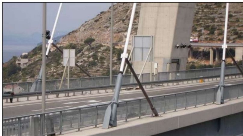
Slika 7: Ugrađeni prigušivači (G. Hrelja, J. Radić, Z. Šavor: Analiza vibracija kosih vješaljki na Mostu Franja Tuđmana u Dubrovniku)
