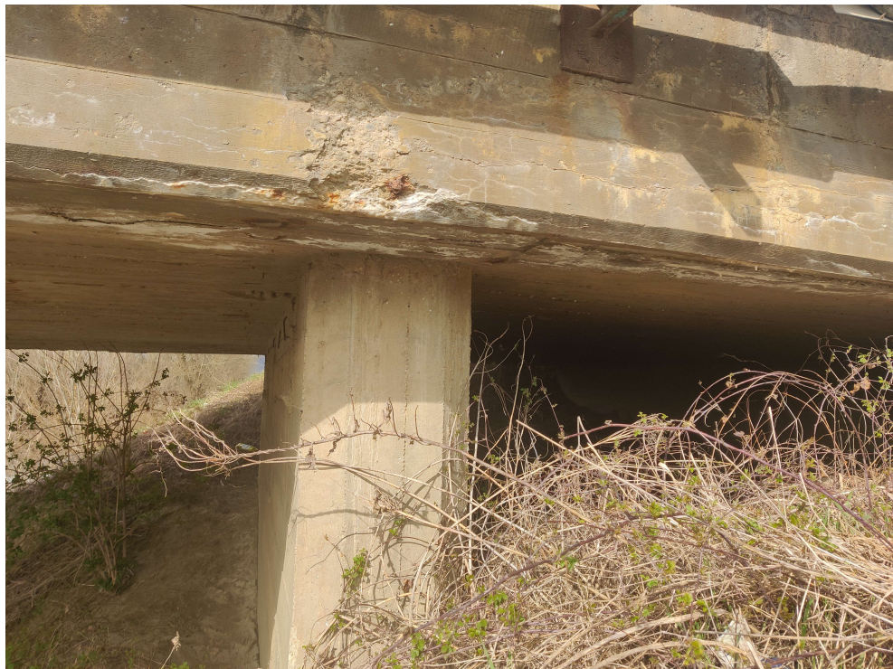
Slika 24: Oštećenje betonske konstrukcije kod oslonca (autorski rad)
