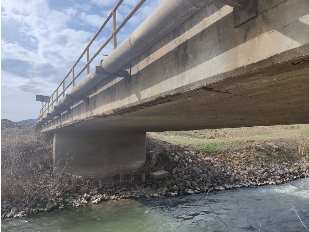
Slika 23: Oštećenje betonske konstrukcije nizvodne strane (autorski rad)
