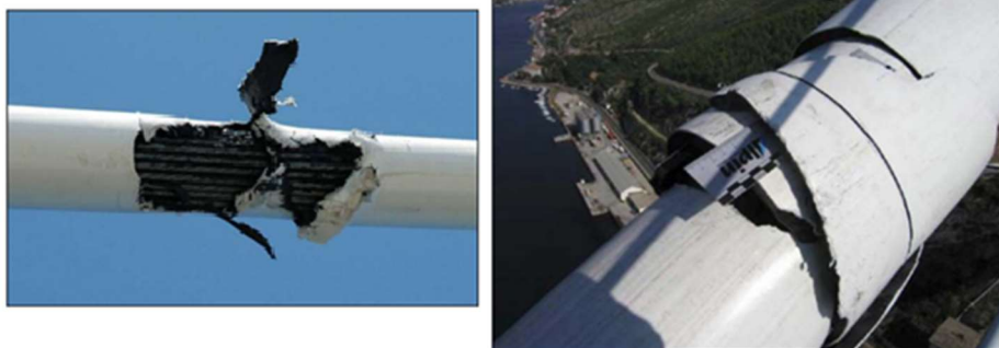
Slika 6: Oštećenje zaštitne cijevi
