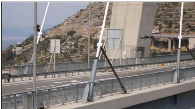
Slika 7: Ugrađeni prigušivači (G. Hrelja, J. Radić, Z. Šavor: Analiza vibracija kosih vješaljki na Mostu Franja Tuđmana u Dubrovniku)
