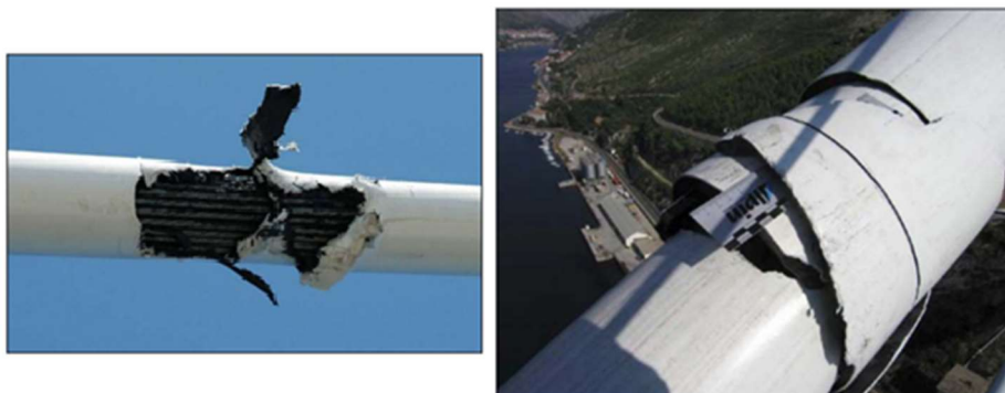
Slika 6: Oštećenje zaštitne cijevi
