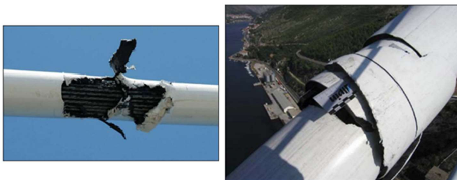
Slika 6: Oštećenje zaštitne cijevi
