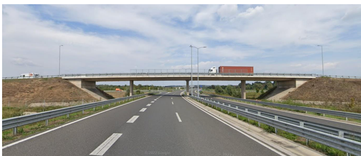
Slika 2.6 Cestovni nadvožnjak na čvorištu preko državne ceste D 10 u naselju Lubena (Izvor: Google karte)
