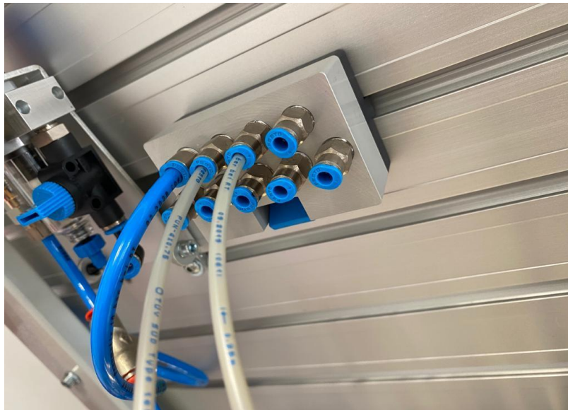
Slika 14 Dovod zraka u pneumatske komponente
