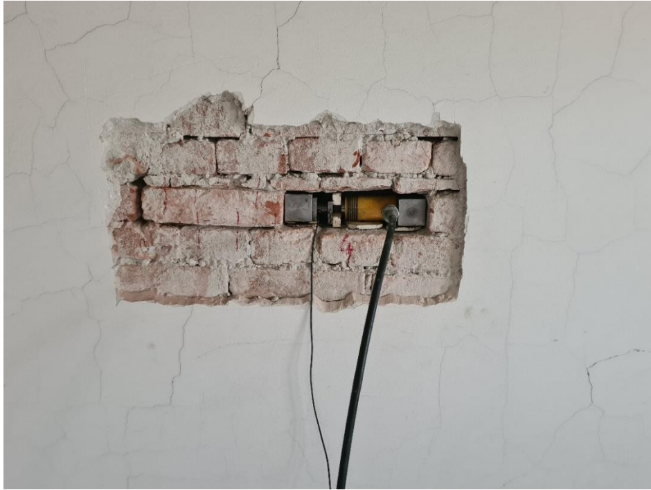
Slika 9. Ispitivanje posmične čvrstoće zida in situ
