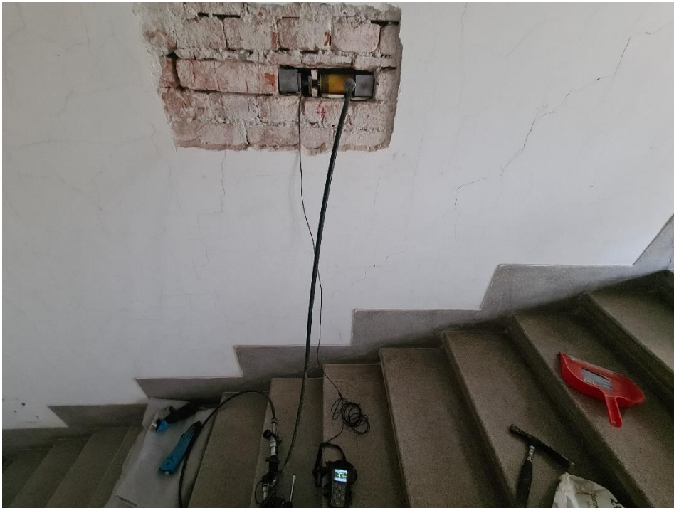
Slika 10. Ispitivanje posmične čvrstoće zida in situ
