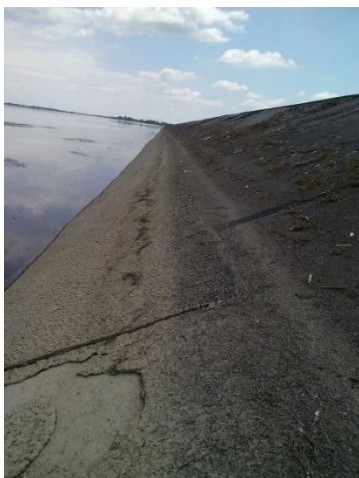
Slika 4. Oštećenje AB obloge
