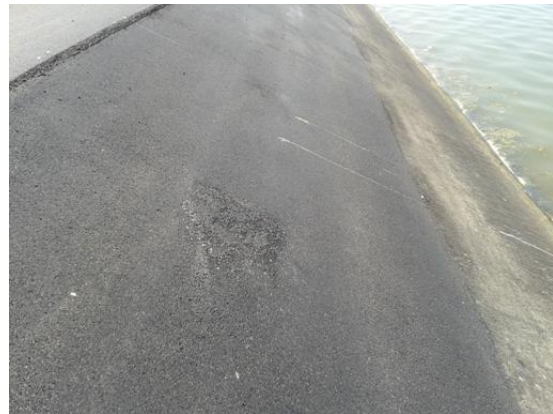
Slika 81. Detalj lokalnih nedostataka na površini izvedenog asfaltnog sloja (gornja zona)
