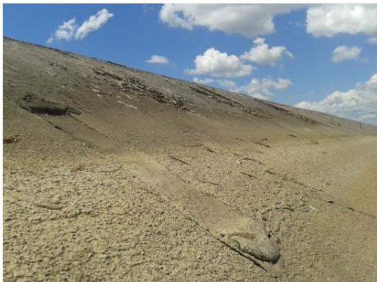
Slika 18. Stanje obloge prije sanacije
