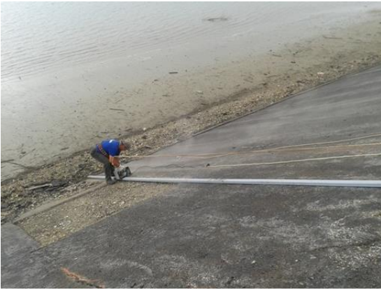
Slika 30. Zarezivanje rubova plošnih oštećenja
