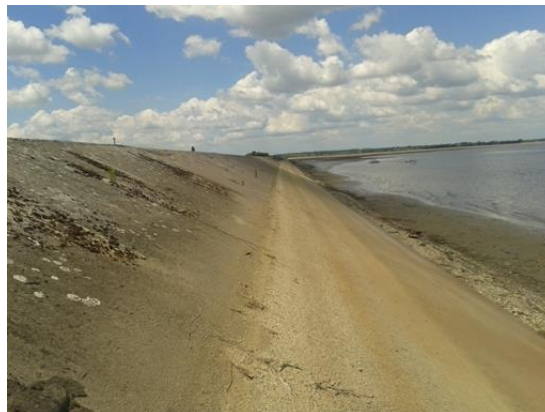
Slika 19. Stanje obloge prije sanacije
