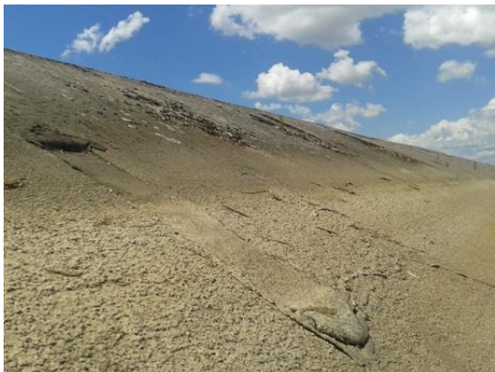
Slika 18. Stanje obloge prije sanacije
