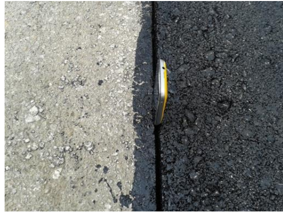
Slika 79. Detalj zarezanog uzdužnog radnog spoja na kruni nasipa (š=1 cm)
