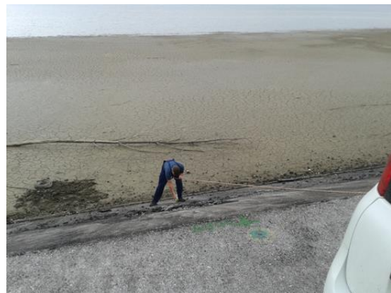
Slika 29. Označavanje granica plošnih oštećenja nosivog asfaltnog sloja
