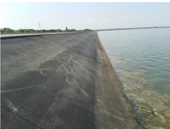
Slika 82. Detalj završenih radova na zamjeni asfalt-betonske obloge kosine nasipa (pri radnoj koti vodostaja akumulacije)
