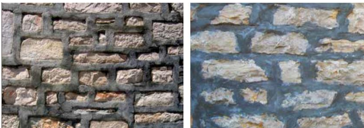
Slika 4.7: Primjer loše izvedenog fugiranja [7]
