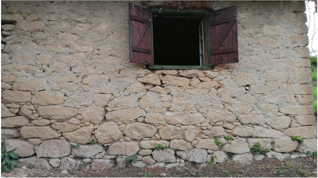
Slika 3.13: Stanje zidova prije čišćenja fuga
