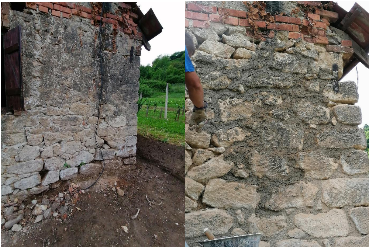
Slika 5.11: Stanje zidova prije i tijekom fugiranja
