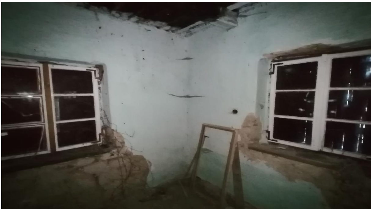
Slika 3.16: Stanje unutrašnjih zidova – prostorija 3
