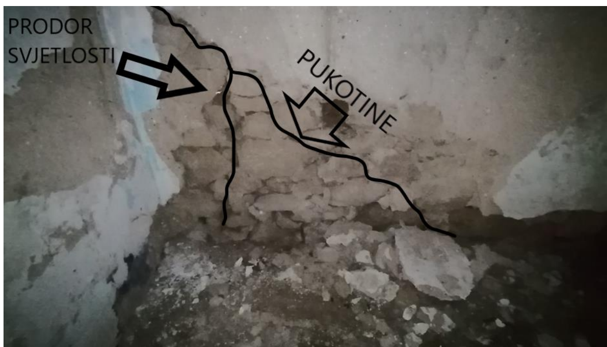
Slika 5.15: Prikaz oštećenja X1
