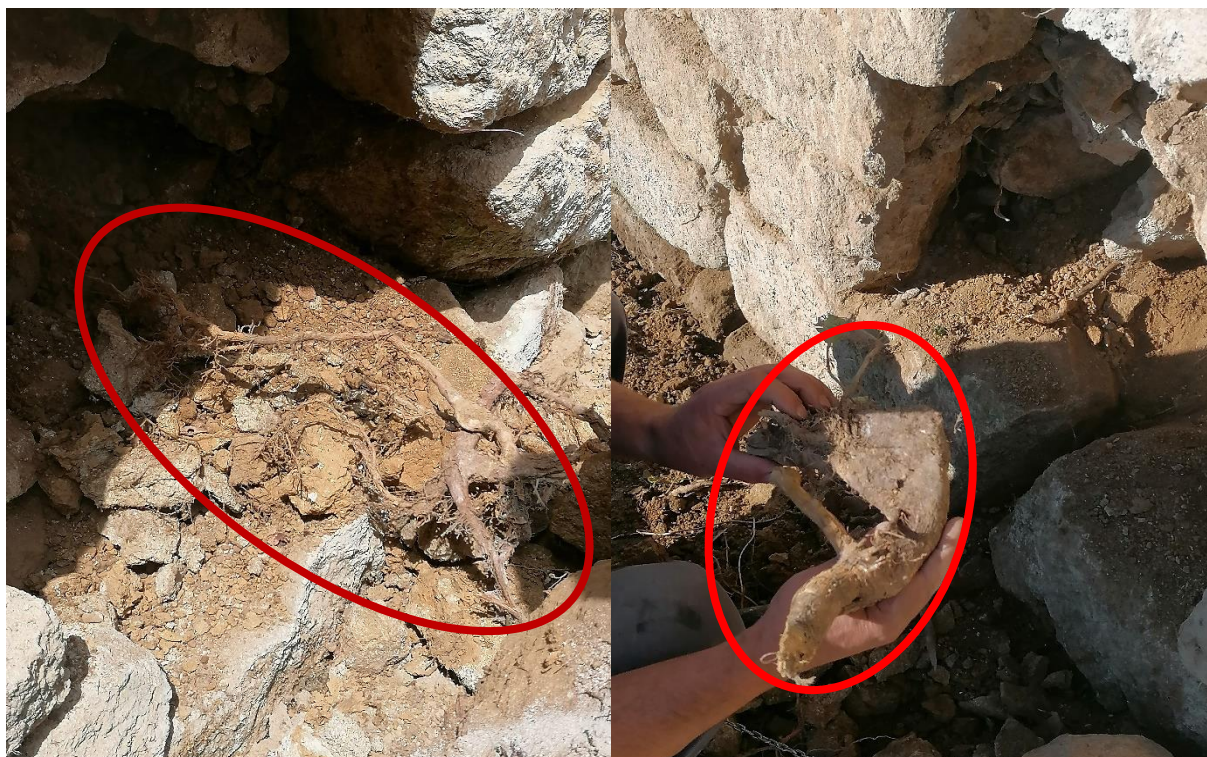
Slika 3.22: Prikaz korijenja prilikom iskopa s vanjske strane objekta
