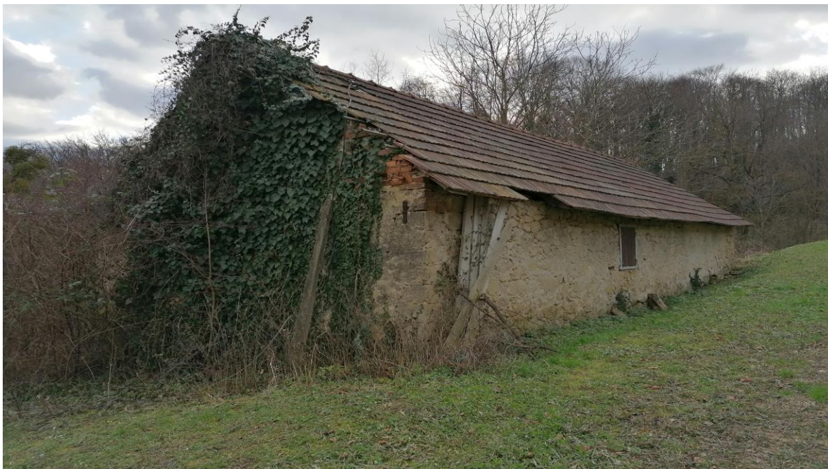
Slika 3.6: Zatečeno stanje – sjeveroistočno pročelje
