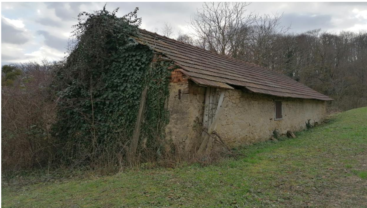
Slika 3.6: Zatečeno stanje – sjeveroistočno pročelje
