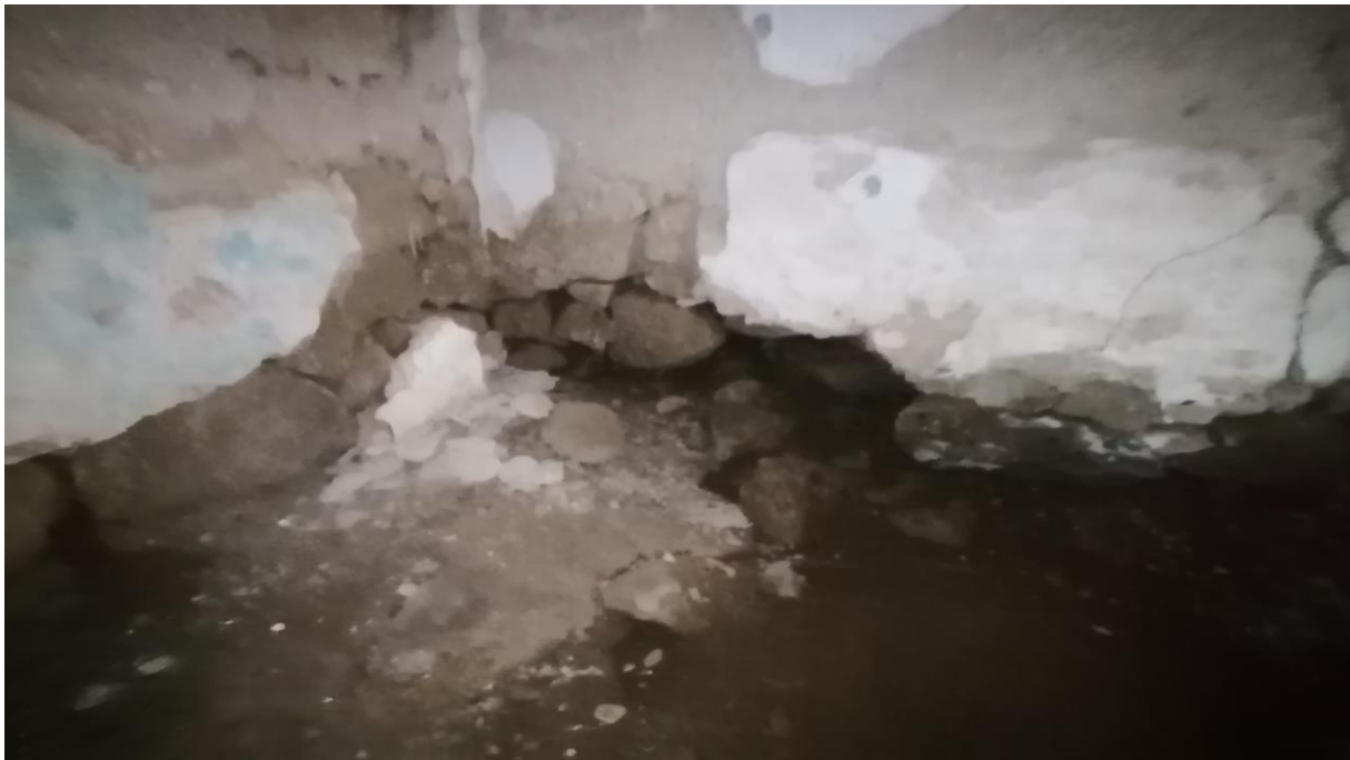
Slika 3.15: Stanje unutrašnjih zidova – prostorija 1
