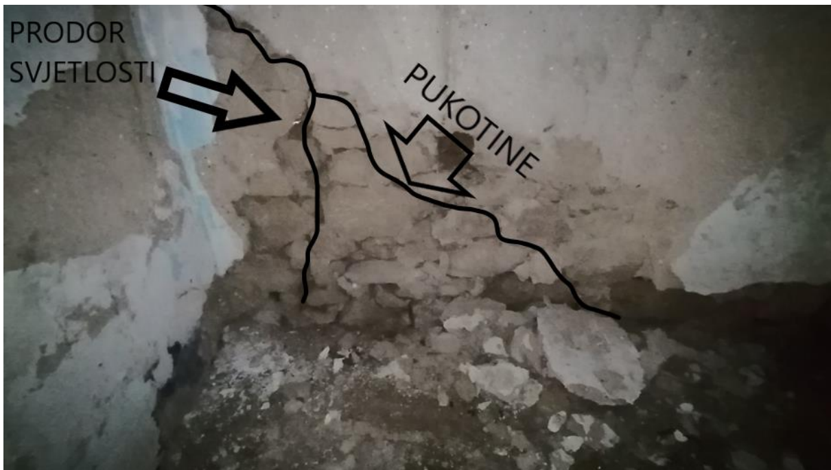
Slika 5.15: Prikaz oštećenja X1
