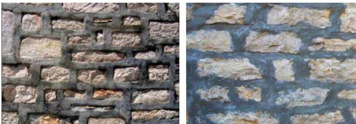
Slika 4.7: Primjer loše izvedenog fugiranja [7]
