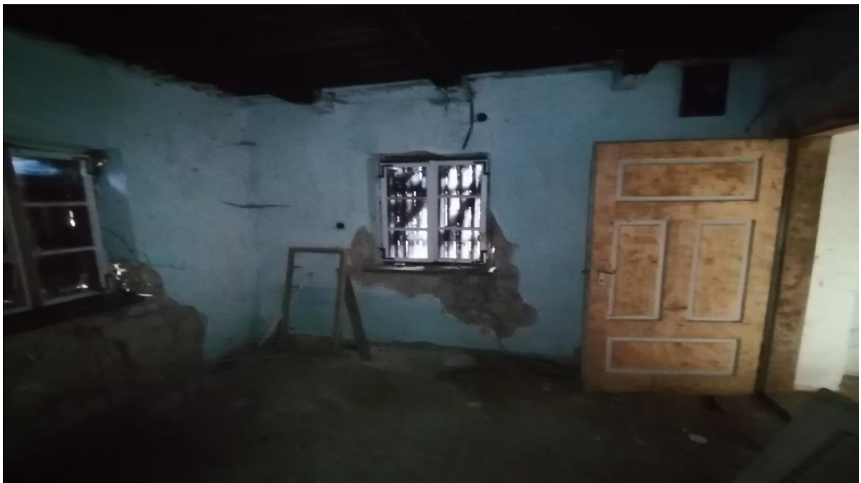
Slika 3.20: Stanje unutrašnjih zidova – prostorija 3
