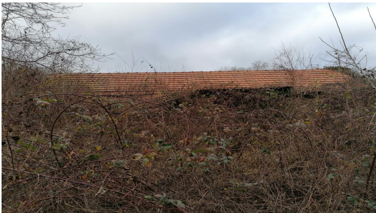
Slika 3.4: Zatečeno stanje – jugoistočno pročelje (bliži kadar)
