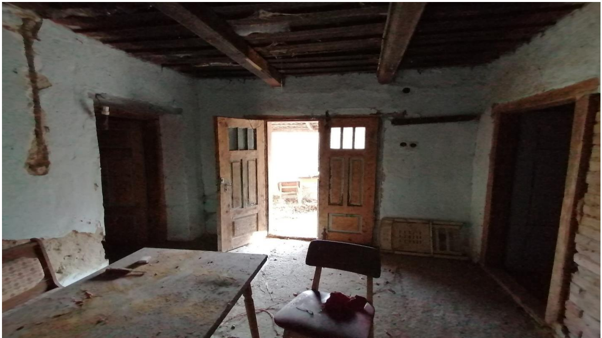
Slika 3.19: Stanje unutrašnjih zidova – prostorija 2
