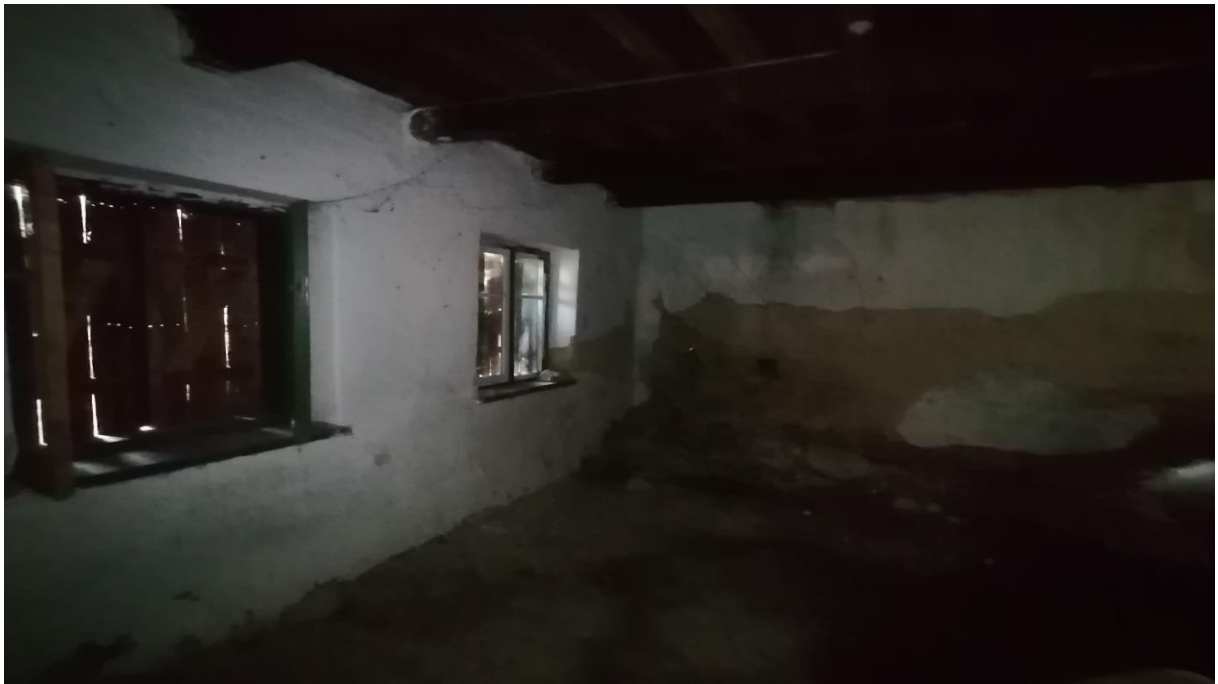
Slika 3.17: Stanje unutrašnjih zidova – prostorija 1
