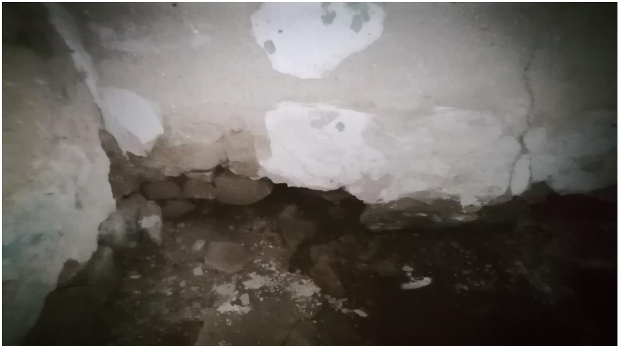
Slika 3.14: Stanje unutrašnjih zidova – prostorija 1
