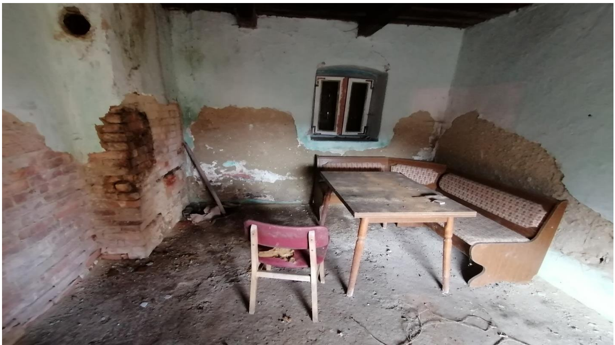
Slika 3.18: Stanje unutrašnjih zidova – prostorija 2
