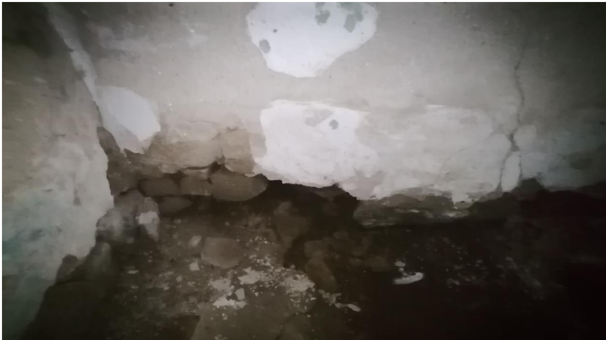
Slika 3.14: Stanje unutrašnjih zidova – prostorija 1
