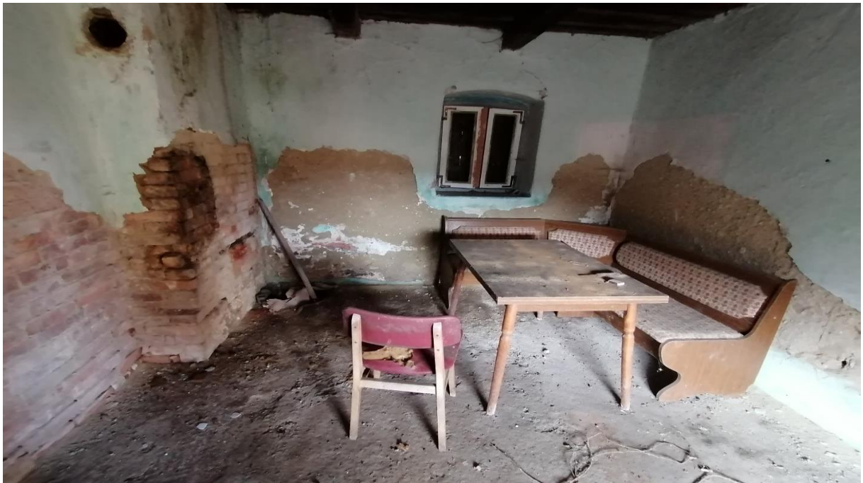
Slika 3.18: Stanje unutrašnjih zidova – prostorija 2
