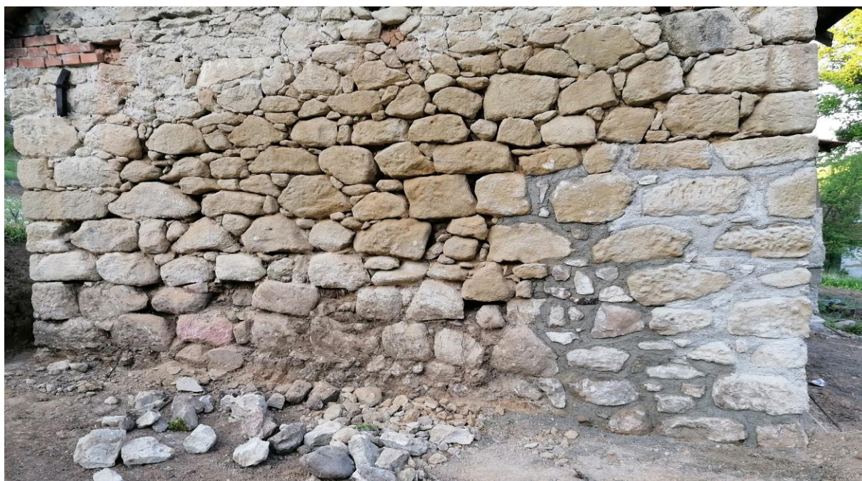
Slika 5.10: Stanje zidova prije fugiranja
