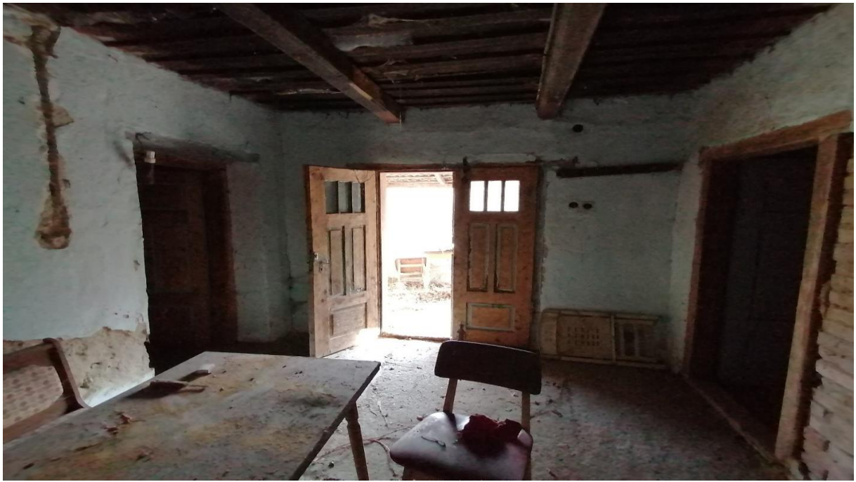
Slika 3.19: Stanje unutrašnjih zidova – prostorija 2
