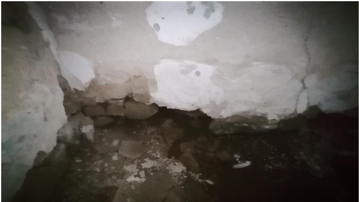
Slika 3.14: Stanje unutrašnjih zidova – prostorija 1
