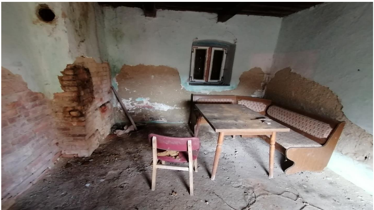
Slika 3.18: Stanje unutrašnjih zidova – prostorija 2
