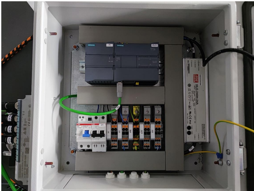
Slika 24. Fotografija unutrašnjosti elektro ormara
