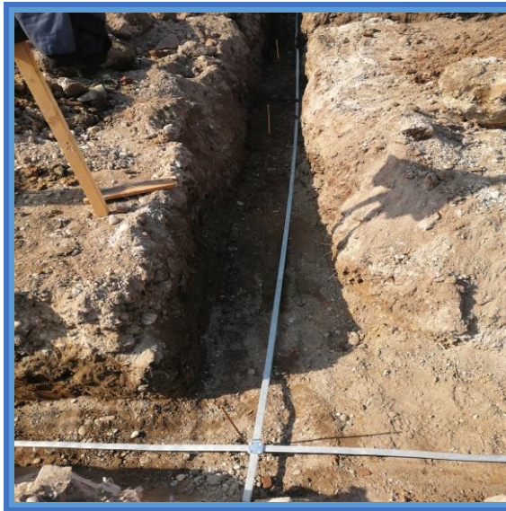
Slika 53. Gromobran u temeljima [8].
