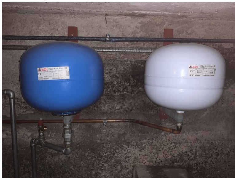
Slika 6.5.2. Ekspanzijske posude spojene na solarni sustav i PTV,(Ivan Podravec-17.4.2023.)
