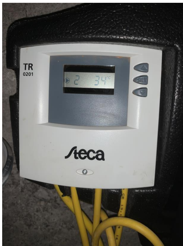
Slika 6.9. Solarni regulator spojen sa električnim naponom i osjetnicima, (Ivan Podravec-2.5.2023.)
