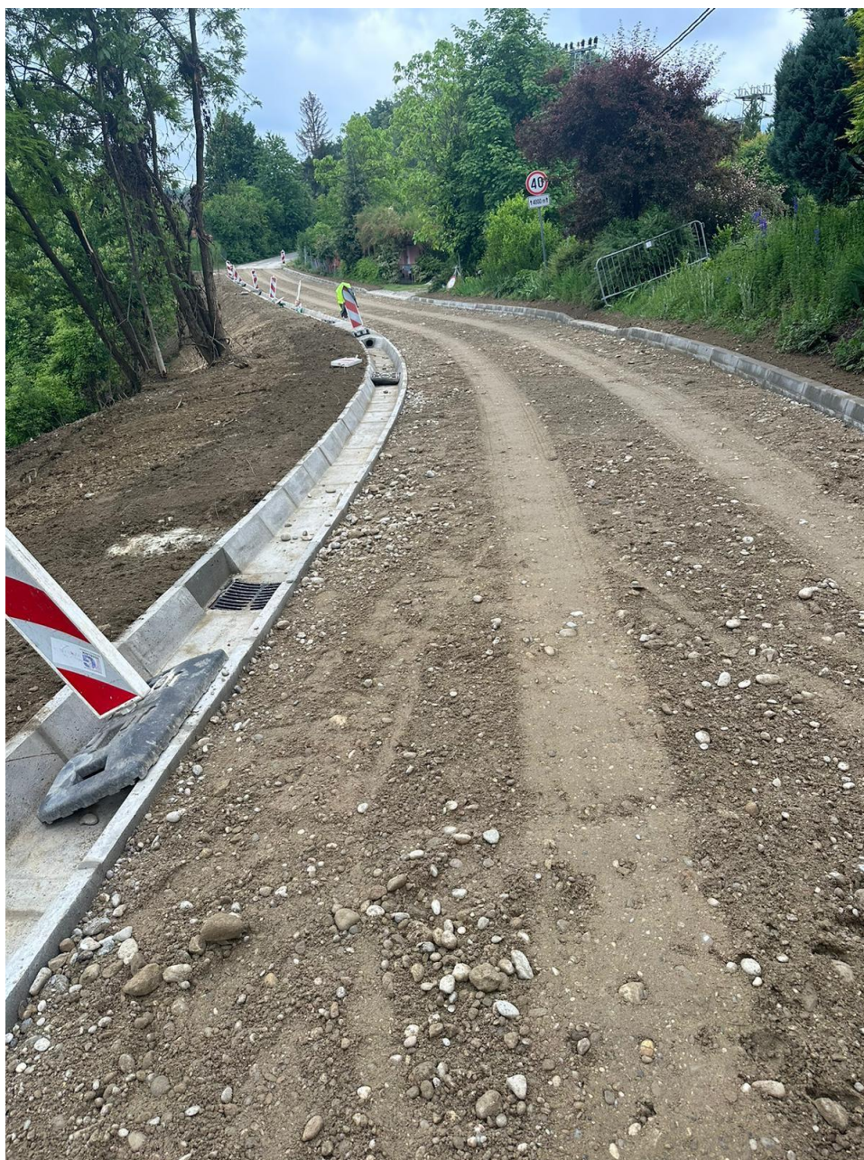
Slika.29. stanje klizišta prije asfalta
