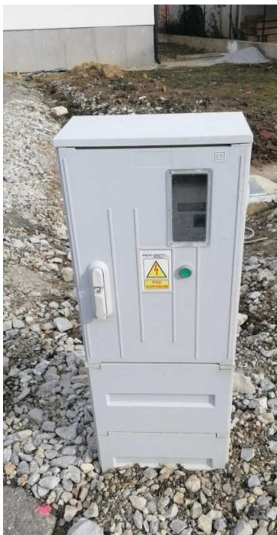
Slika 7. KPMO (kućni priključni mjerni ormar)
