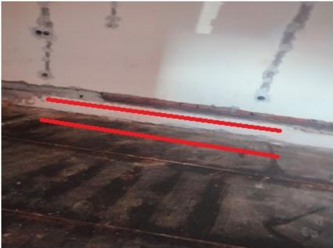
Slika 3.11 – Pukotina između zida i temeljne ploče
