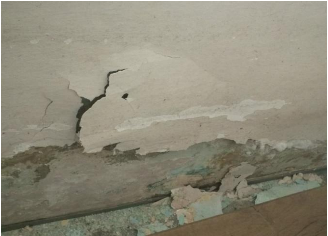
Slika 3.6 – Oštećenja od vlage
