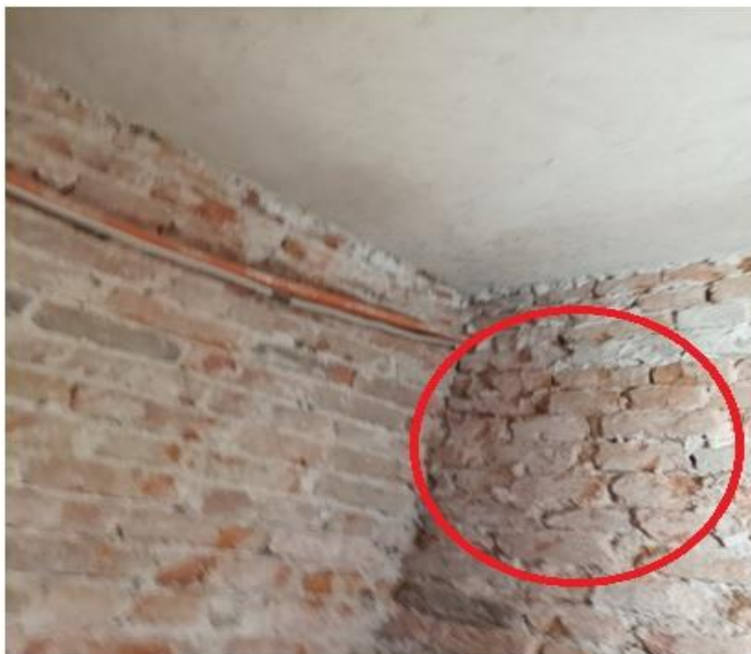
Slika 3.10 – Pukotine na zidovima
